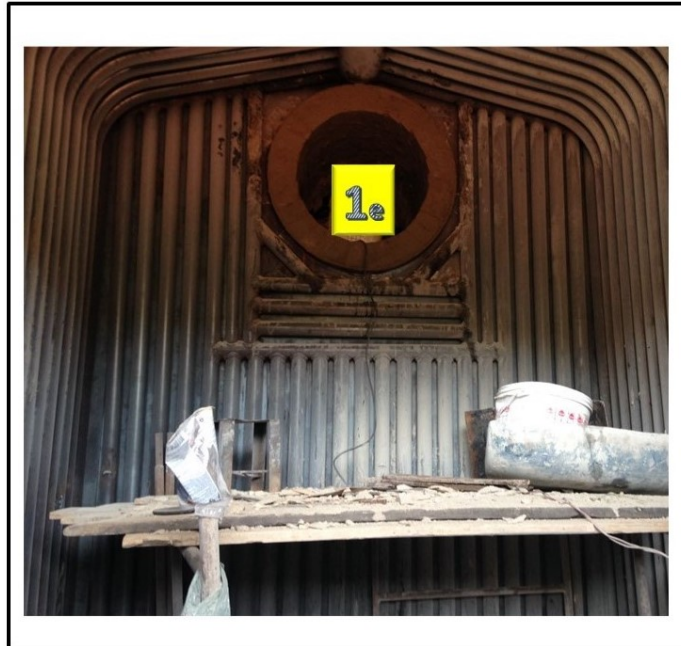
Figura 11: Tubo principal de saída dos gases da combustão
