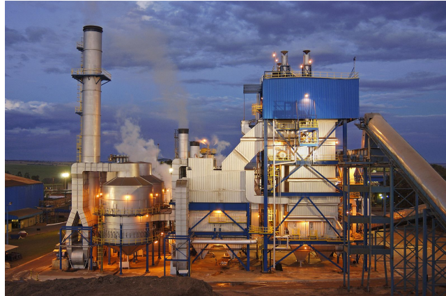
Figura 3: Caldeira em funcionamento
