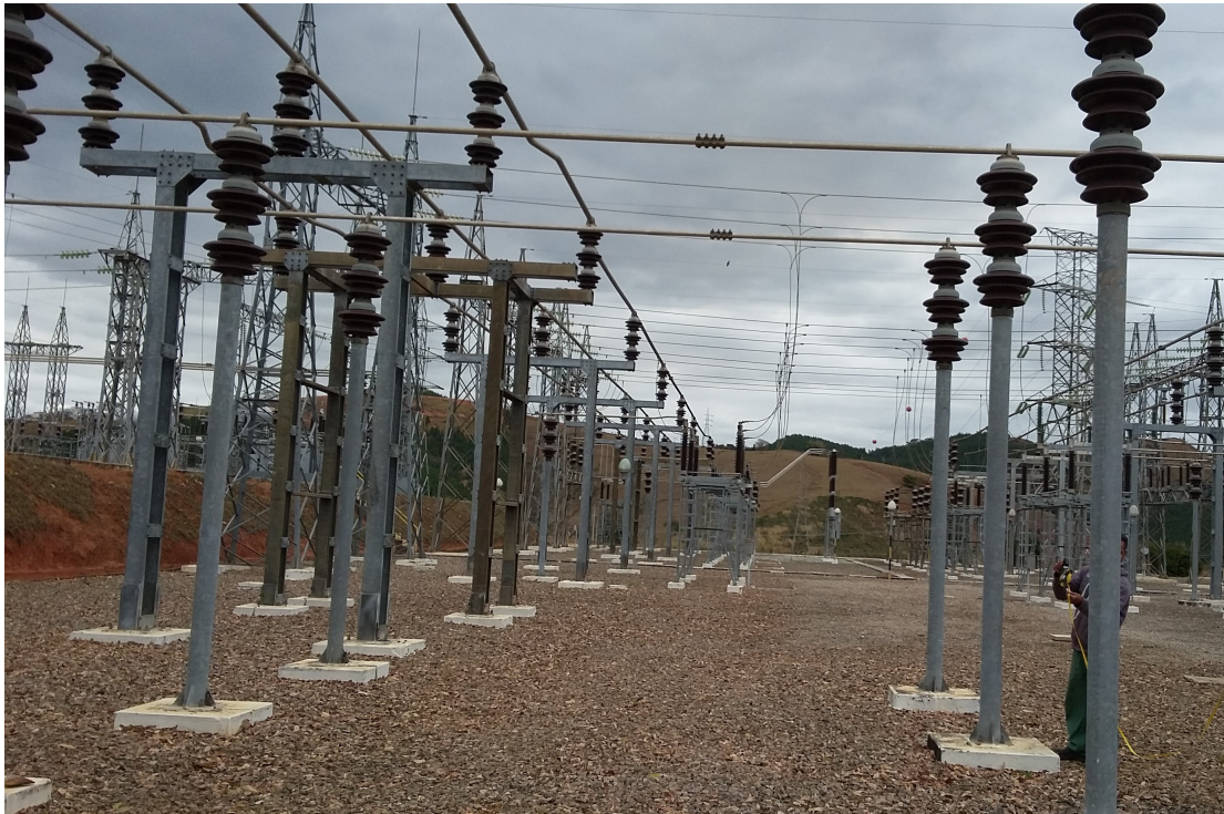
Figura 14: Barramento da subestação CEMIG
