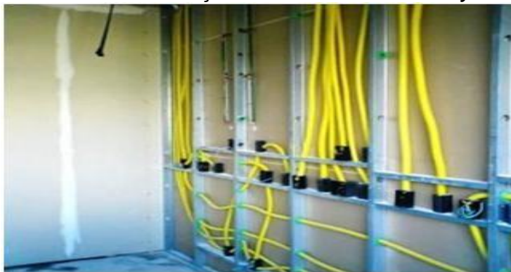
FIGURA 6 - Instalação elétrica no sistema Drywall
