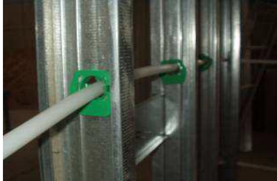
Figura 11- Passagem de tubulação PEX no montante com passador para proteger a tubulação contra desgastes da parede e possíveis cortes.
