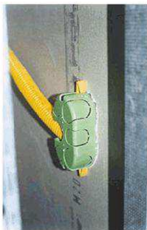
Figura 16 - Instalação de caixa de luz específicas no sistema Drywall com chapas de gesso acartonado
