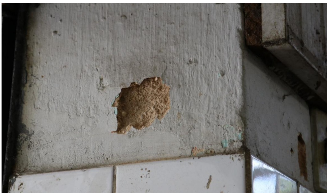
FIGURA 15 – Desagregação do concreto: porosidade e desagregação do concreto
