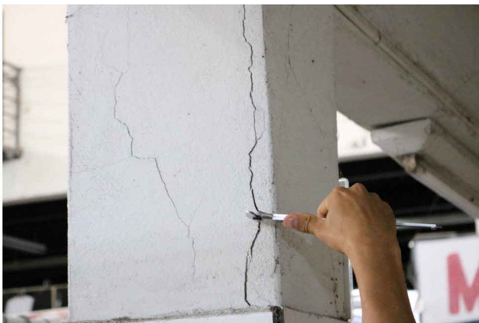
FIGURA 19- Pilar com duas manifestações patológicas, trinca e rachadura
