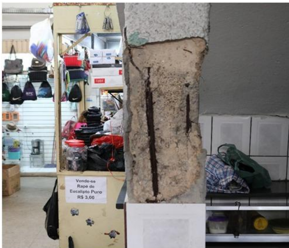
FIGURA 18 - Patologia no pilar: corrosão da armadura
