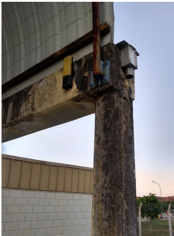
Figura 10: Pilar em estado de deterioração devido umidade excessiva (Autores, 2019).
