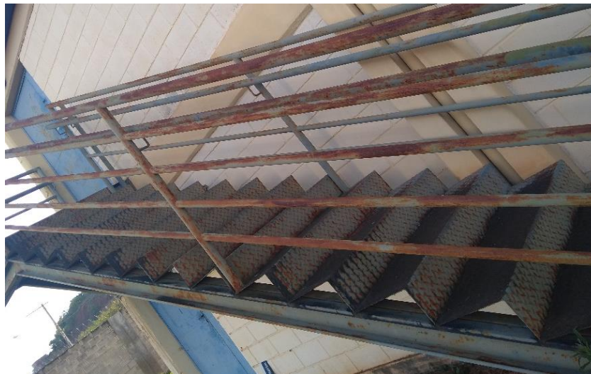
Figura 8: Escada na parte externa da edificação acometida por corrosão (Autores, 2019)
