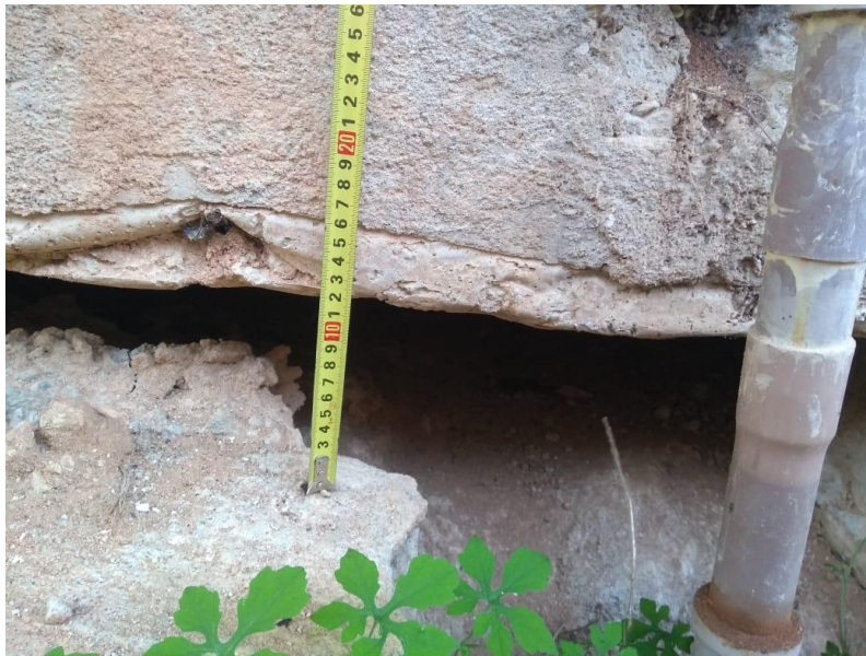
Figura 11: Recalque no perímetro externo do Módulo Restaurante
