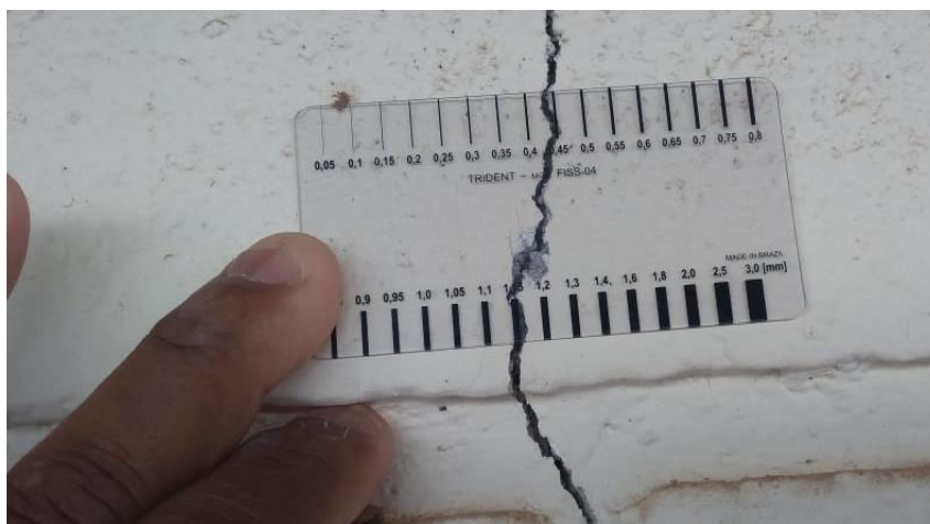
Figura 6: Rachadura em alvenaria de vedação do lado externo da sala de treinamento (Autores, 2019).
