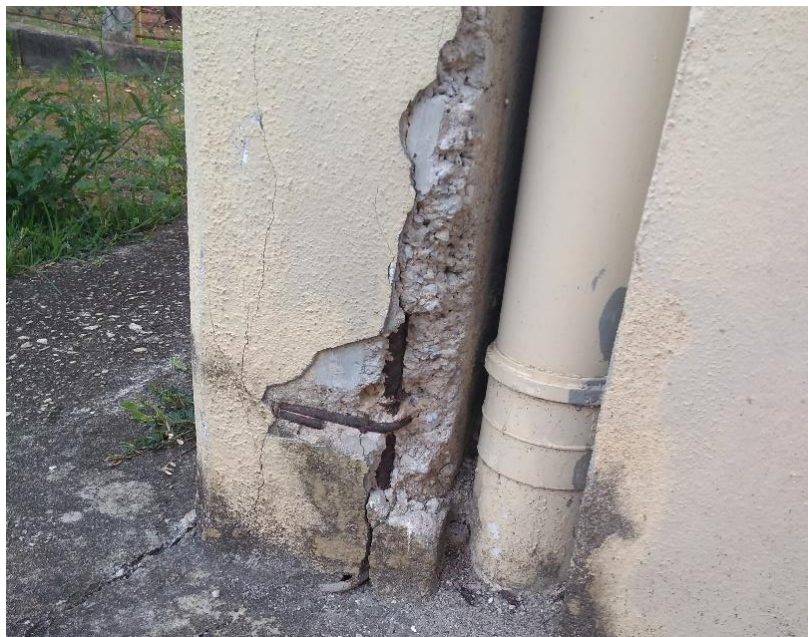
Figura 9: Armadura de Pilar de Canto Exposta (Autores, 2019)
