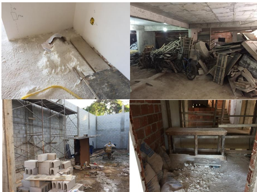
Figura 6: Desperdícios de materiais encontrados nos canteiros
