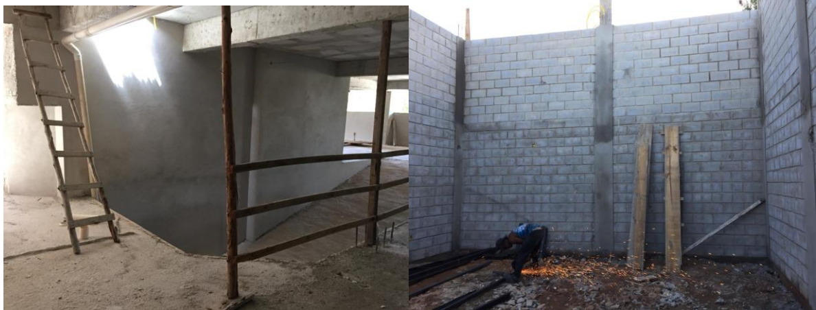
Figura 4: Situações de risco de acidentes nos canteiros visitados
