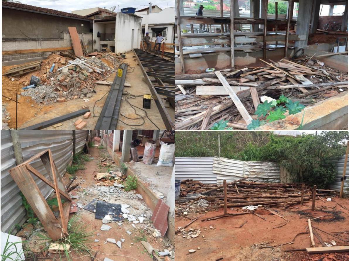
Figura 5: Acúmulo de resíduos nos canteiros visitados
