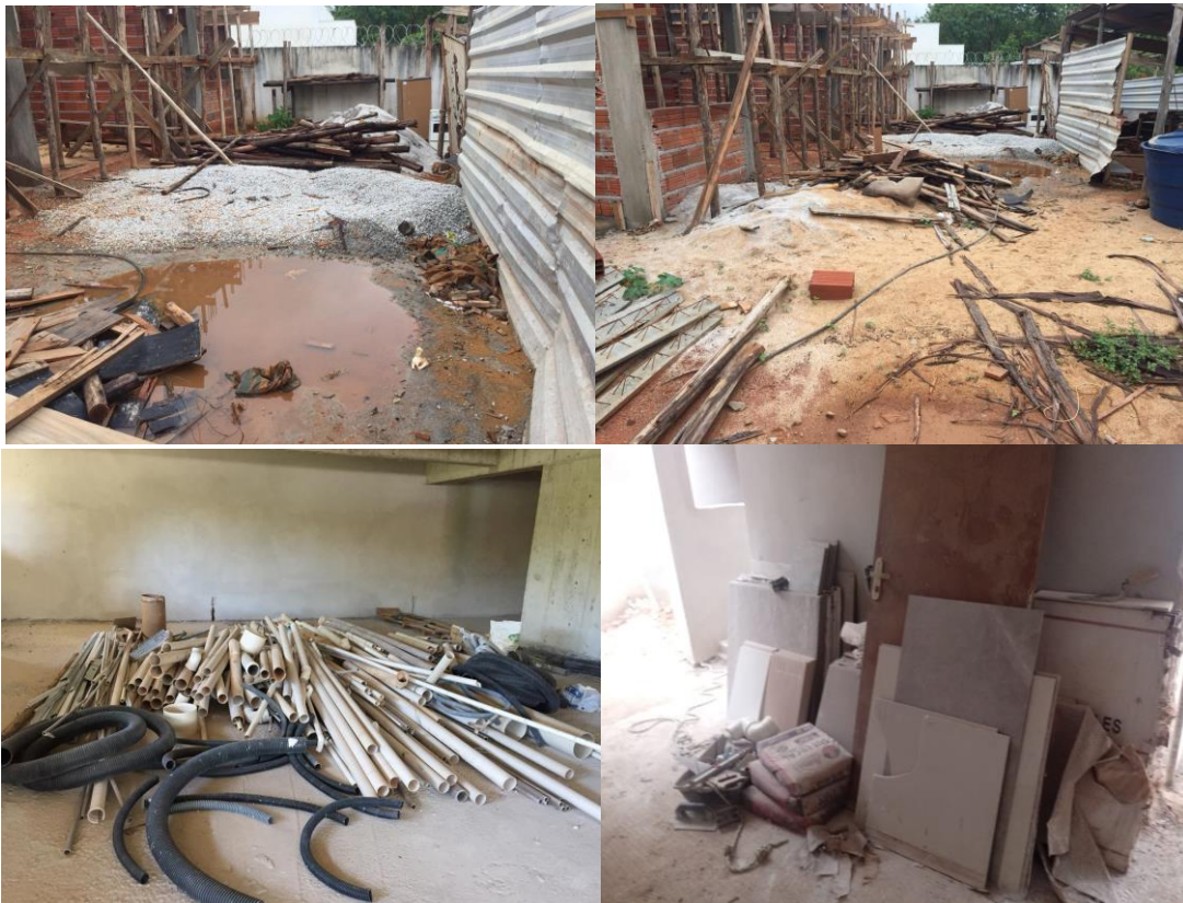
Figura 8: Armazenamento incorreto de materiais encontrado nos canteiros de obras
