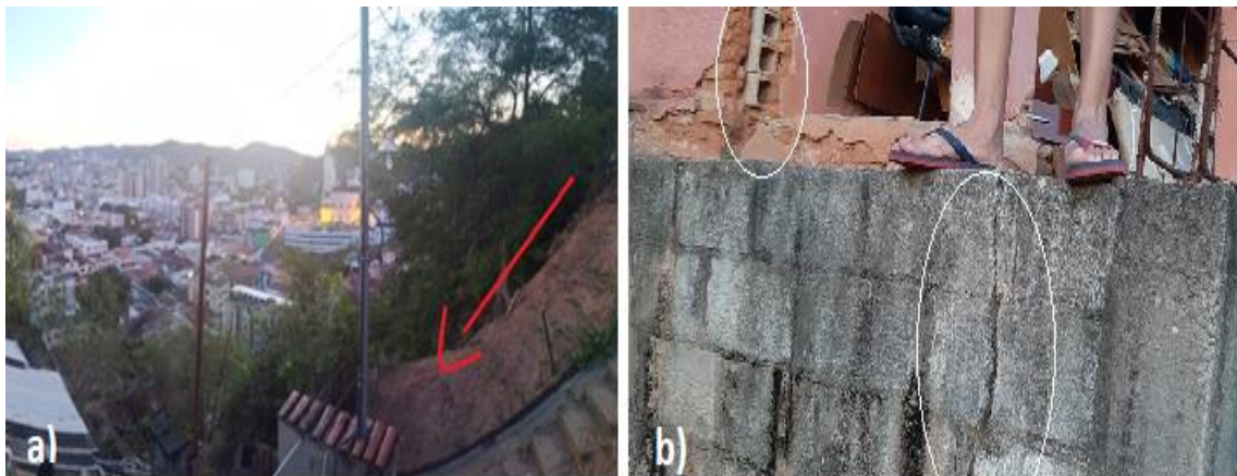
Figura 8. Vista do talude pelo final da Travessa 52 (a), e danos estruturais na residência (b). (Acervo do autor, 2019)
