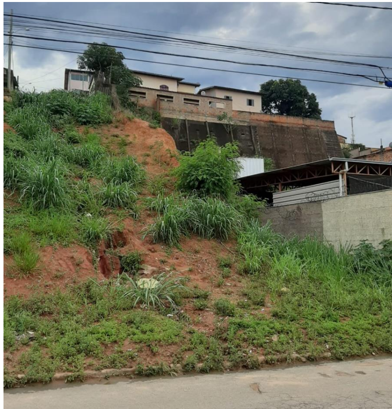
Figura 6. Foto tirada da Rua Carlos Leonardt, mostrando o talude onde era pra ser um acesso para a travessa Mucuri. (Acervo do autor, 2019)
