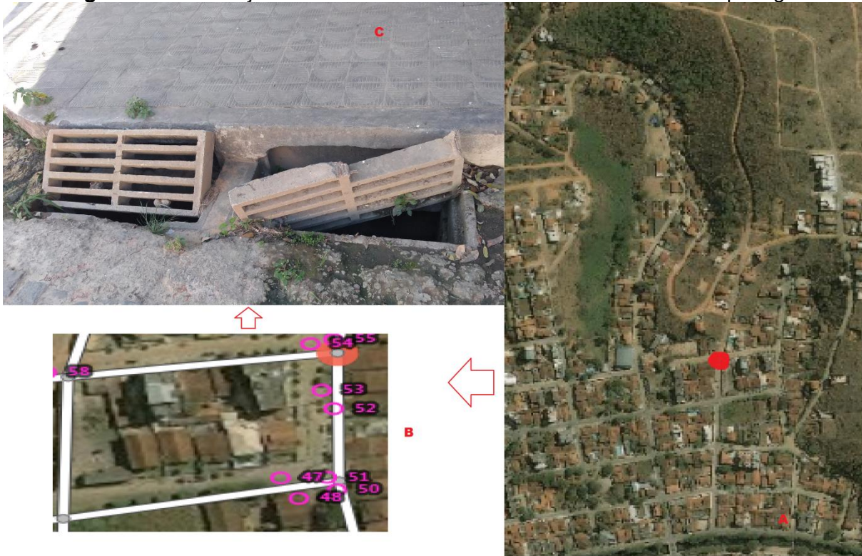
Figura 3: Identificação de boca de lobo na Rua Gustavo Pechir Bairro Ipiranga.
