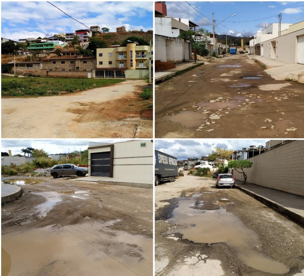
Figura 5: Pontos de deficiência na drenagem do residencial laranjeiras
