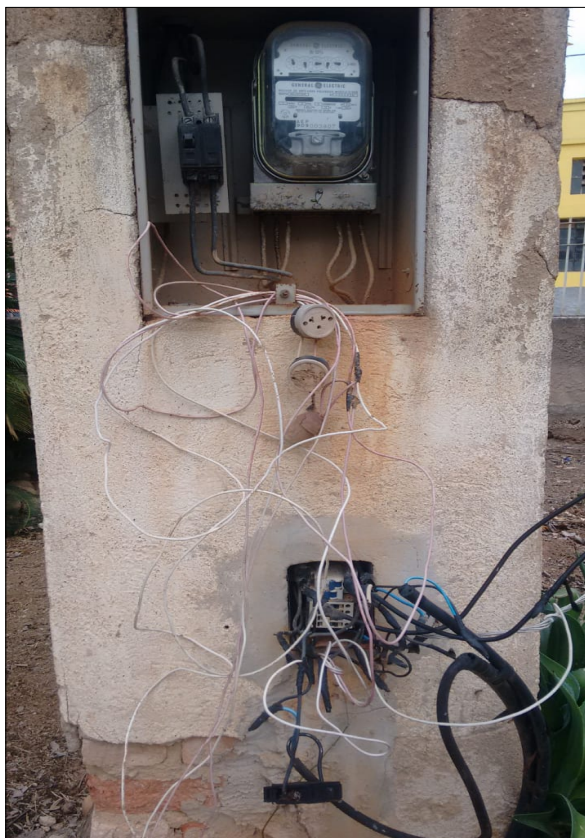
FIGURA 08: Quadro de alimentação
