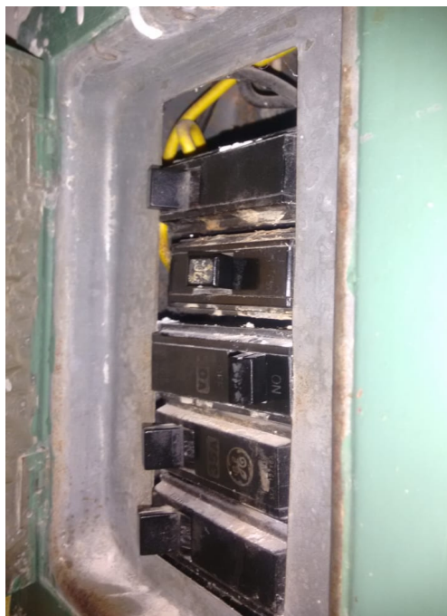
FIGURA 09: Quadro de Distribuição 01
