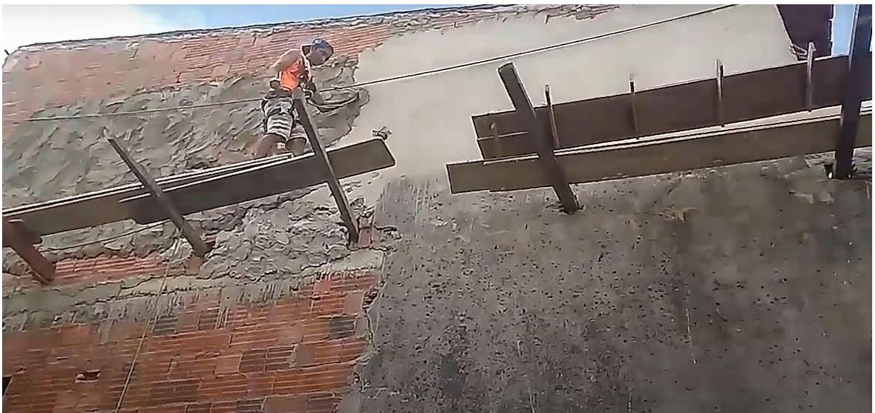
Figura 2 - Trabalho Irregular em Altura
