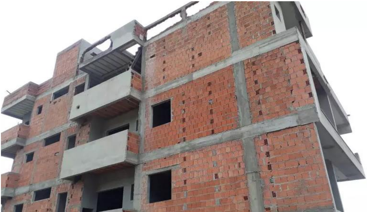
Figura 4 - Edifício sem Proteções Coletivas
