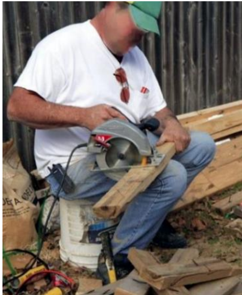
Figura 3 - Uso Incorreto de Ferramenta
