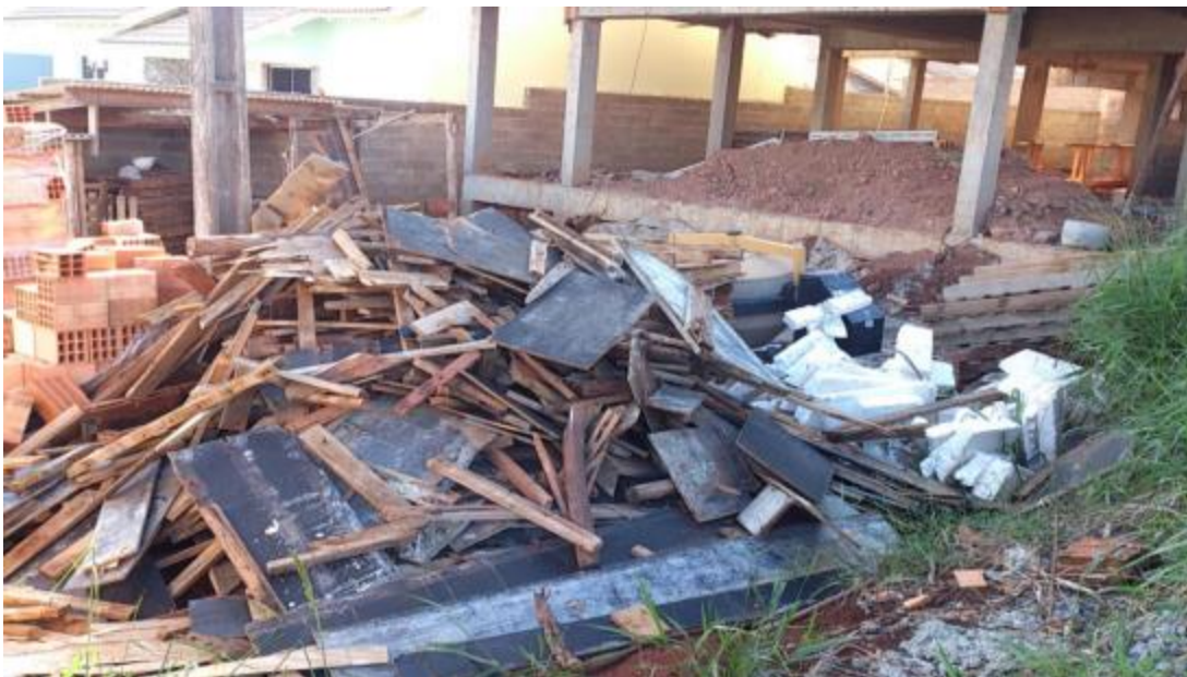
Figura 5 - Canteiro de Obra Desorganizado
