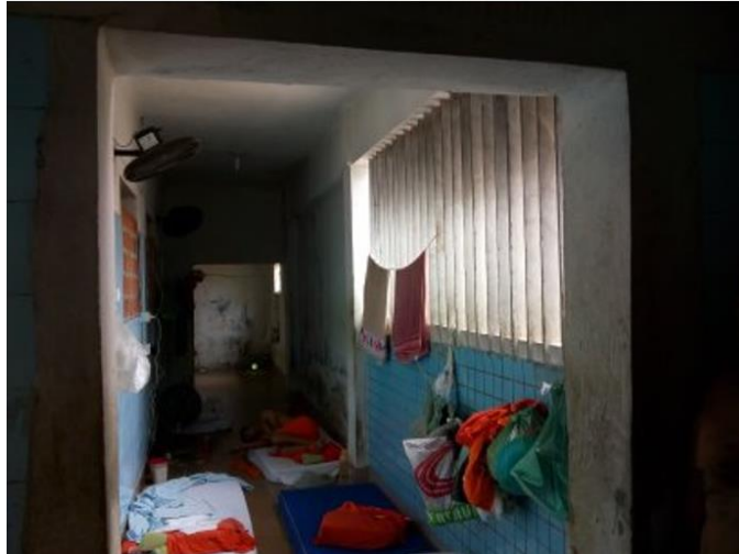
Foto 4: Corredor insalubre, com roupas estendidas no varal e colchões ao chão. Fonte: Inspeção Nacional de Hospitais Psiquiátricos, 2018.
