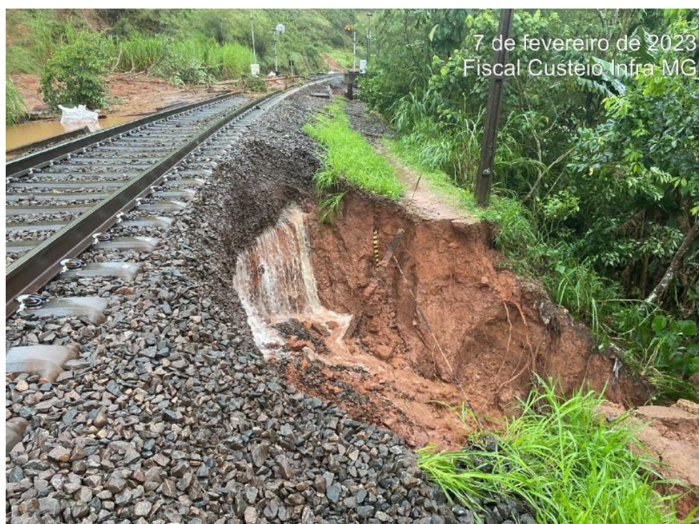
Figura 15- Foto da erosão da plataforma ferroviária
