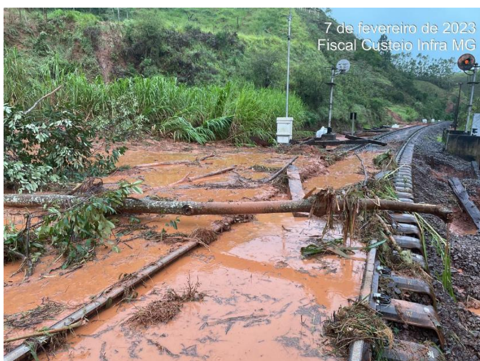
Figura 17- Foto do acúmulo de material na malha ferroviária
