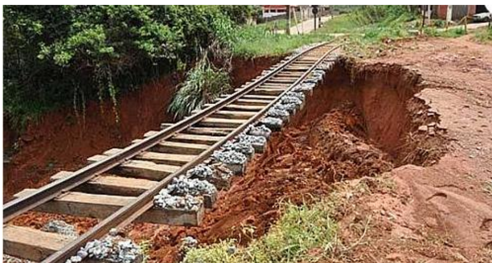
Figura 3 - Erosão em ferrovia
