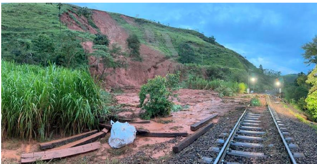
Figura 18- A cobertura vegetal nos locais afetados pelo deslizamento
