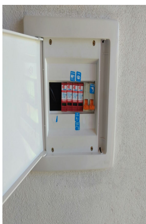
Figura 47: Disjuntor e DPS instalados no local
