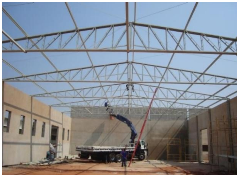
Figura 35: Estrutura metálica como captor natural.
