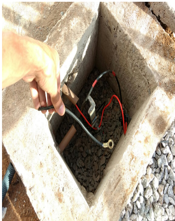
Figura 46: Haste de aterramento utilizado para o neutro da concessionaria
