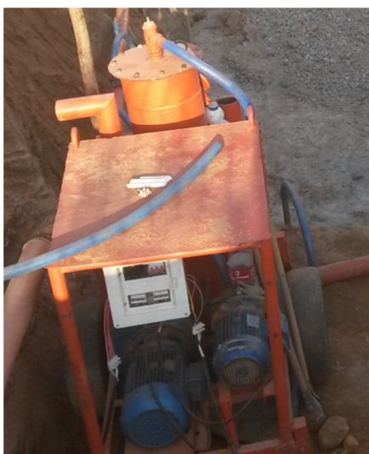
Figura 11: Conjunto de bombas centrífuga e de vácuo.
