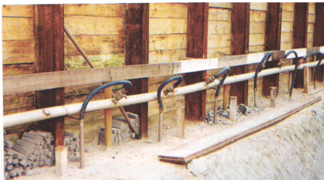
Figura 8: Vista do conjunto das ponteiros acopladas ao tubo coletor.
