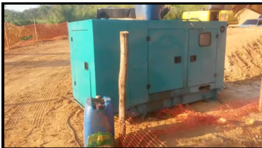
Figura 53: Gerador a diesel.
