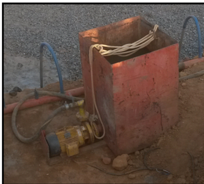
Figura 46: Reservatório e bomba de alta pressão.
