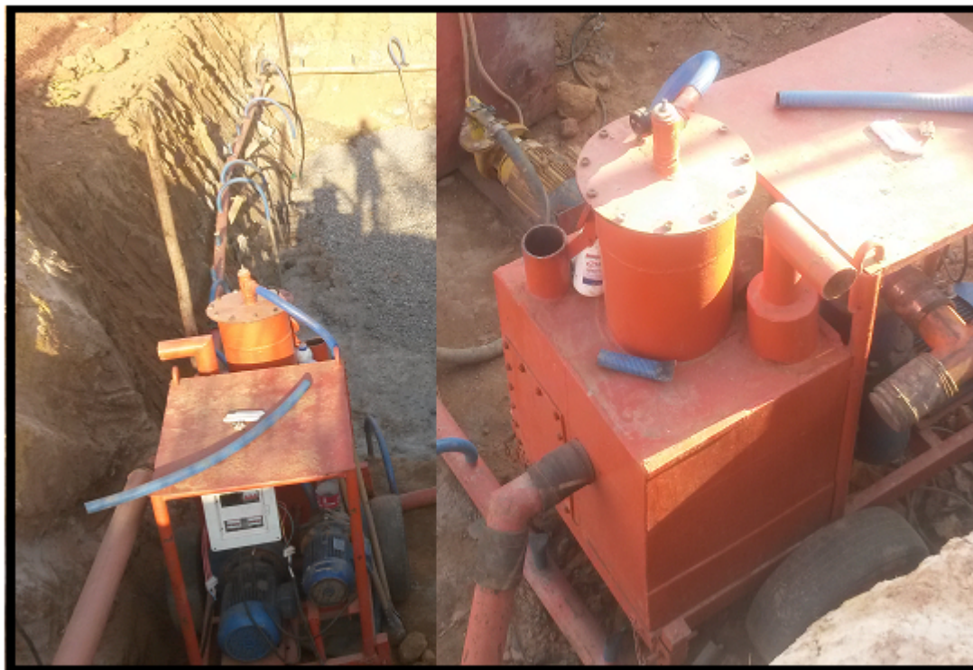
Figura 52: Conjunto de bombas.
