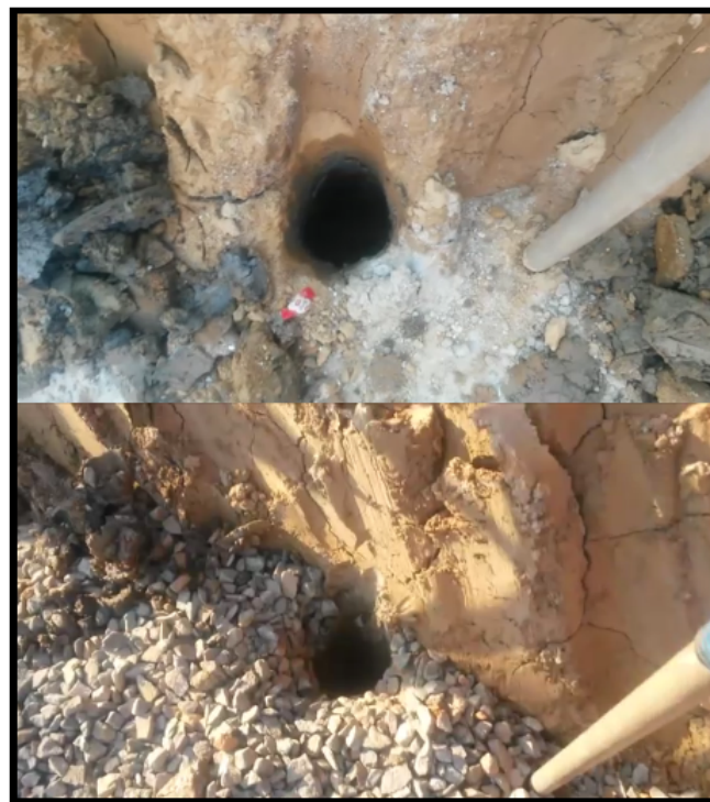
Figura 51: Poços de inspeção. Fonte: Arquivo do Autor.
