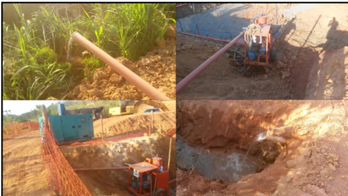
Figura 43: Tubulação de recalque e descarga.
