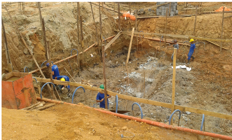
Figura 49: Fundo da vala após a execução das estacas. Fonte: Arquivo do Autor.
