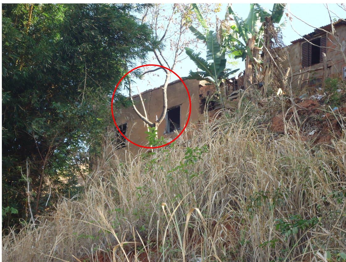
Figura 3: Presença de rachadura em construção localizada em encosta
