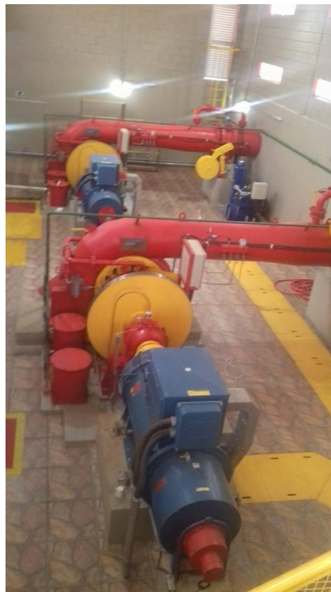
Figura 15: Casa de força da CGH Ponte queimada
