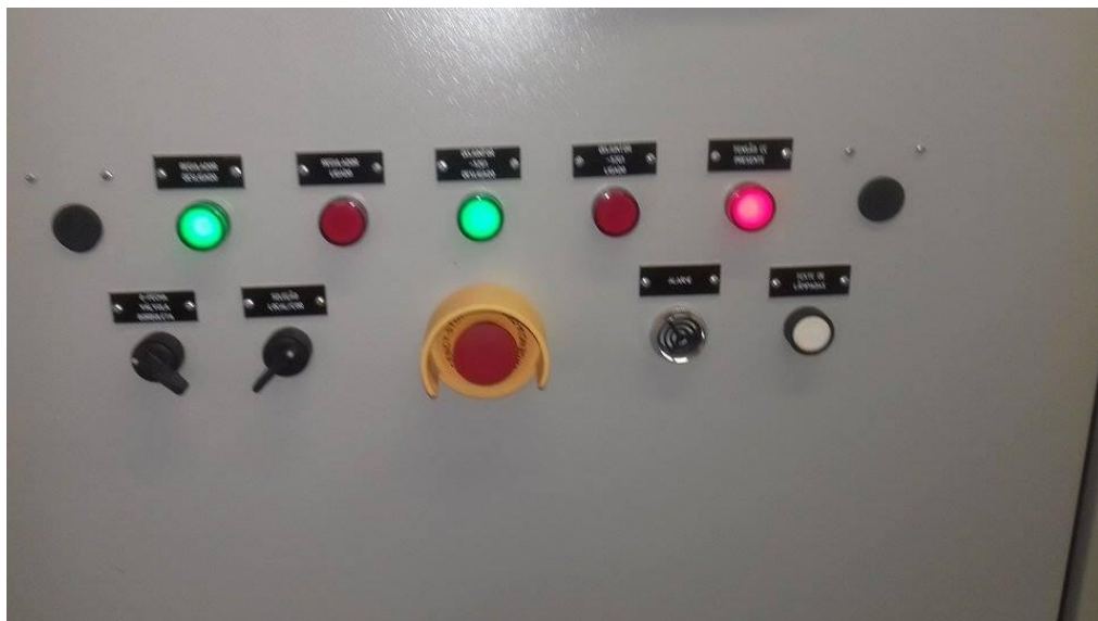
Figura 31: Painel antes de instalação do LED de falha no controle
