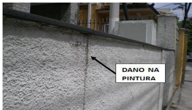
Figura 6: Surgimento de mancha no muro devido à umidade.
