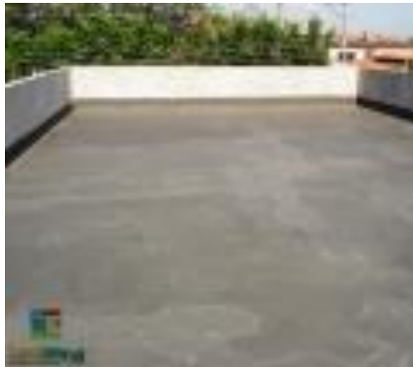
Figura 17: Aplicação da membrana acrílica em uma laje de cobertura com tela estruturante.
