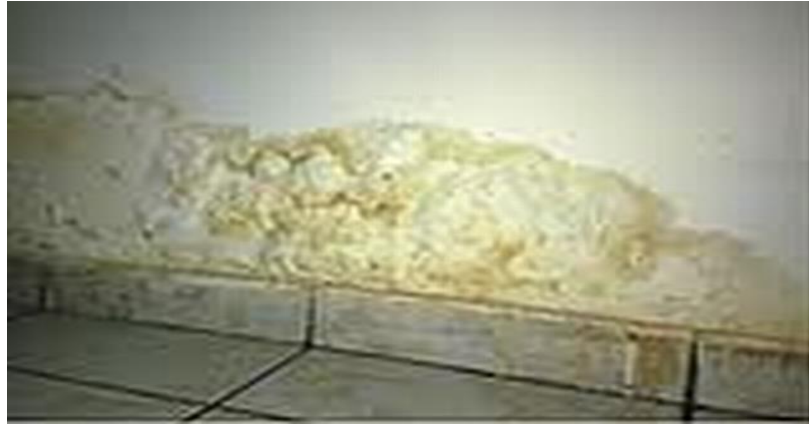
Figura 2: Patologia na área inferior da parede devido umidade ascensional.
