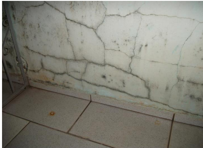
Figura 7: Parede danificada por diversas patologias incluindo o mofo.
