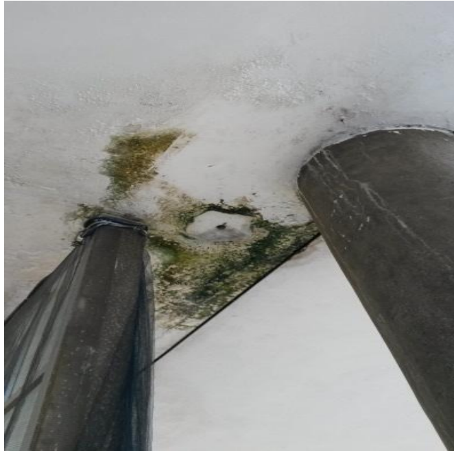
Figura 1 : Infiltração em laje de concreto.
