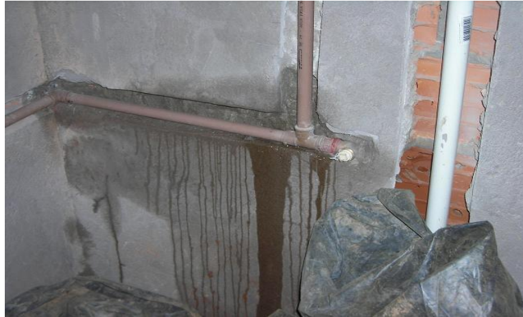
Figura 5: Umidade acidental após falha na execução da instalação hidráulica.
