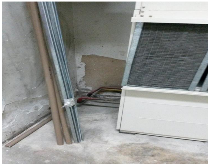
Figura 3: Umidade por condensação em casa de máquinas.
