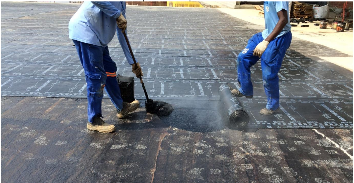
Figura 31: Aplicação da manta asfáltica tipo III com espessura de 4 mm derretida com asfalto polimérico à quente.
