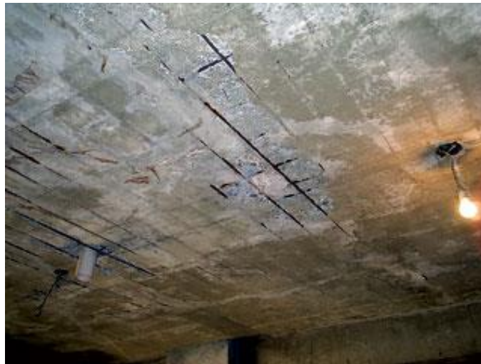
Figura 9: Problemas que a corrosão pode causar nos elementos construtivos.
