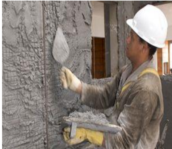
Figura 4: Exemplo de umidade contida nos materiais na fase de construção da obra.
