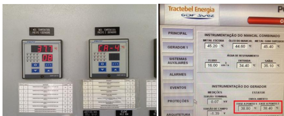
Figura 2 - Indicador de temperatura do Estator do Gerador
