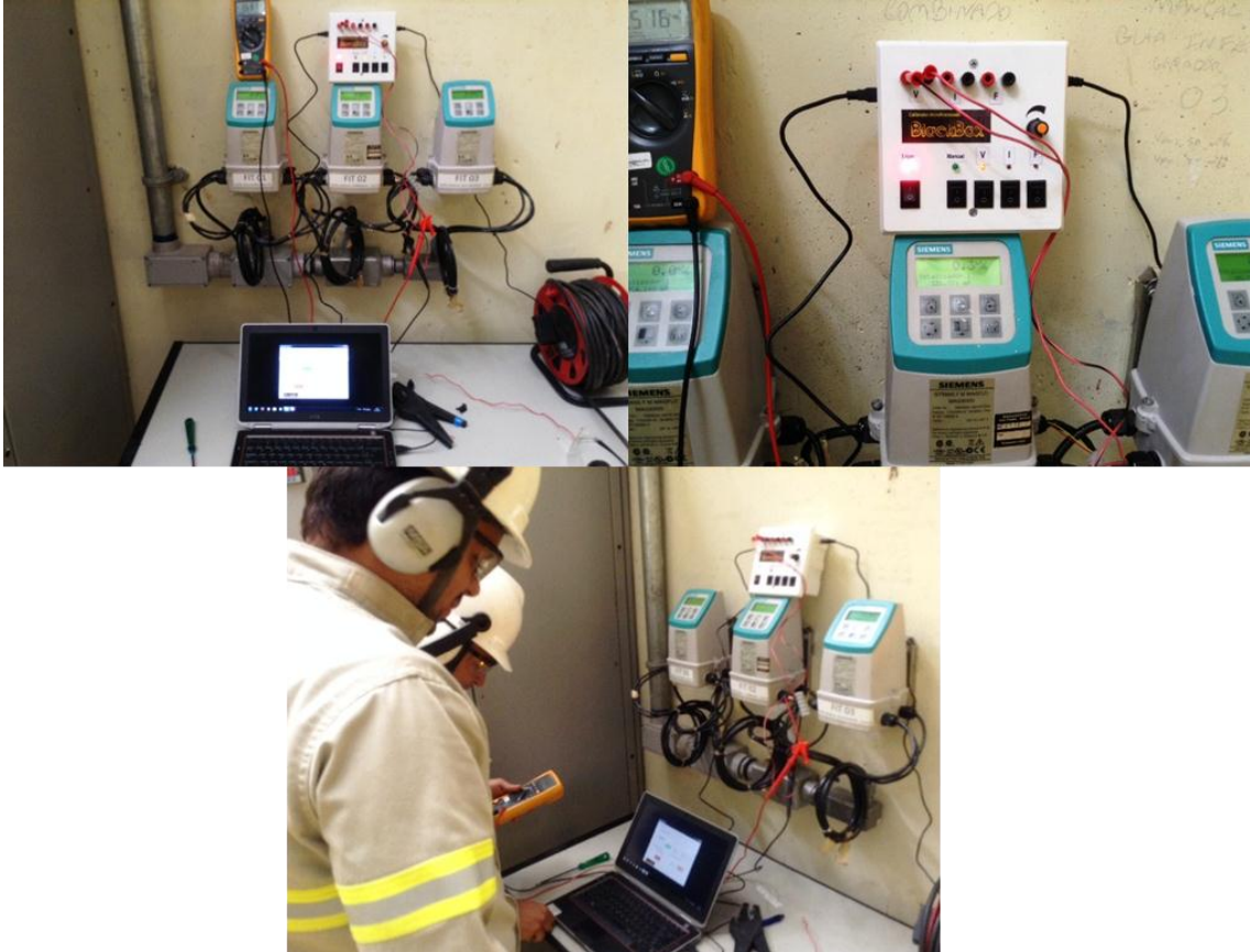
Figura 3 - Verificação medição de vazão água de resfriamento mancal do gerador
