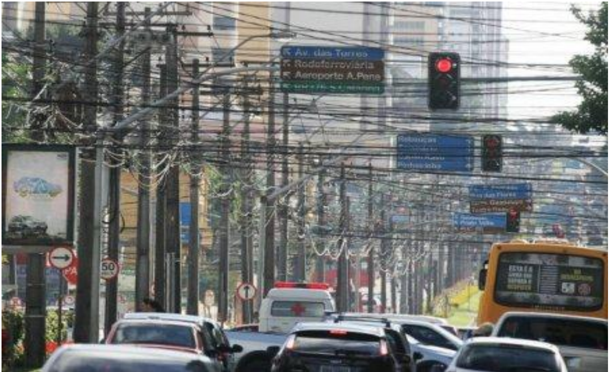
FIGURA 14 - Rede de Distribuição Aérea Fonte: COPEL (2012)
