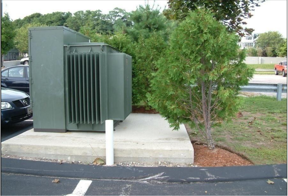
FIGURA 21 - Transformador do tipo pedestal em meio à paisagem urbana Fonte: http://www.copel.com
