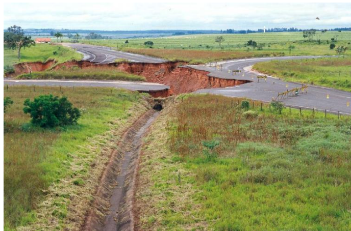
FIGURA 5.7 – RODOVIA DANIFICADA POR EROSIÃO EM MATO GROSSO DO SUL.
