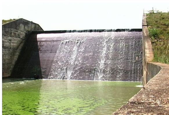
Figura 21: Água atingiu o vertedouro na barragem da Corsan em Passo Fundo
