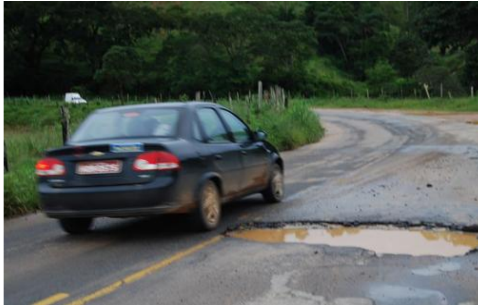
Figura 6 - Comprometimento de uma das vias da pistas por buracos, falta de acostamento e drenagem. http://www.giro21.com.br/mat_vis.aspx?cd=6519
