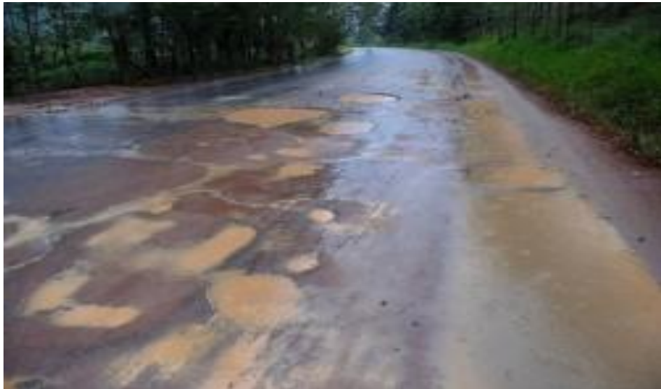
Figura 9 - Comprometimento das duas vias da pistas por buracos, falta de acostamento, sinalização e drenagem. http://www.giro21.com.br/mat_vis.aspx?cd=6519
