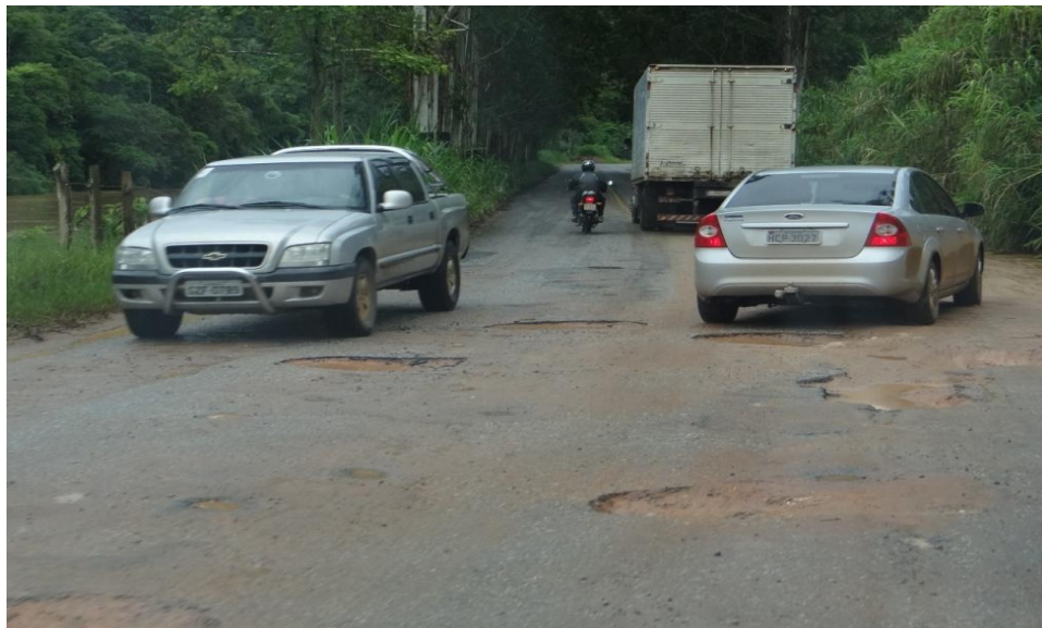
Figura 7 - Comprometimento das duas vias da pistas por buracos, falta de sinalização horizontal, acostamento e drenagem . http://www.giro21.com.br/mat_vis.aspx?cd=6519
