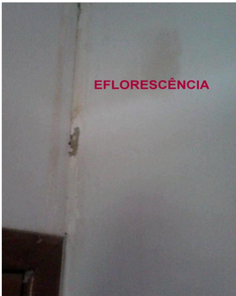
Figura 5 - Mofo e Eflorescência
