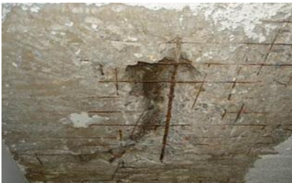
Figura 10 - ilustra a corrosão das armaduras.
