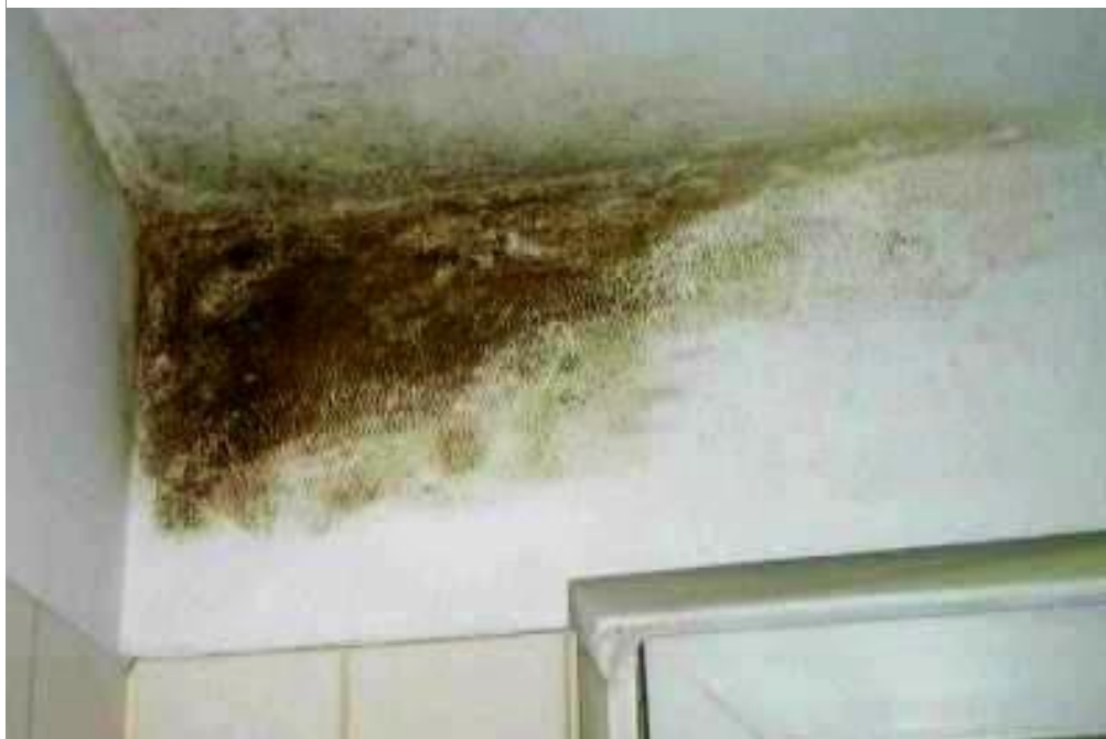
Figura 9 - ilustra o bolor no interior da edificação.
