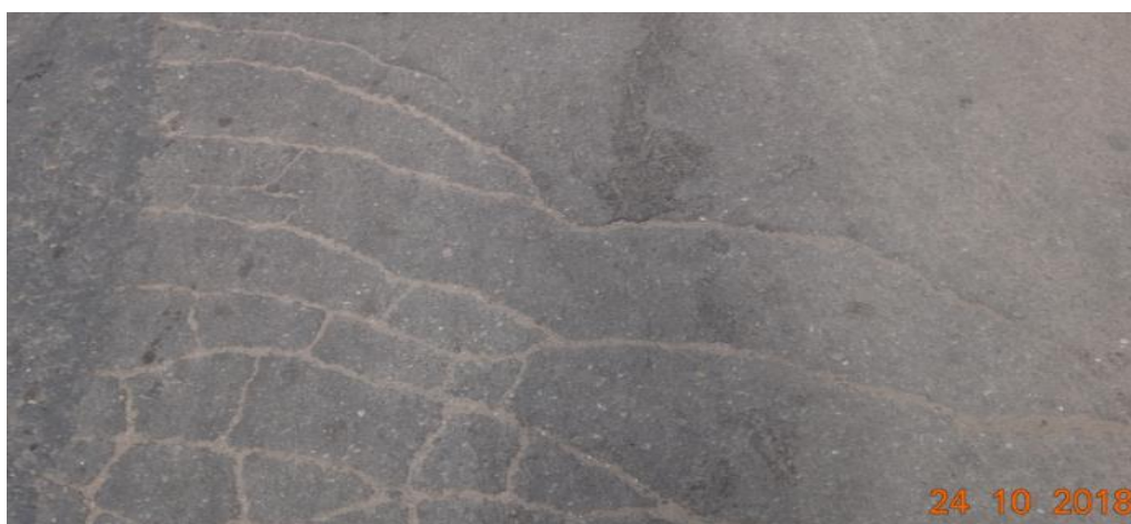
Figura 16 Trinca Transversal Curta
