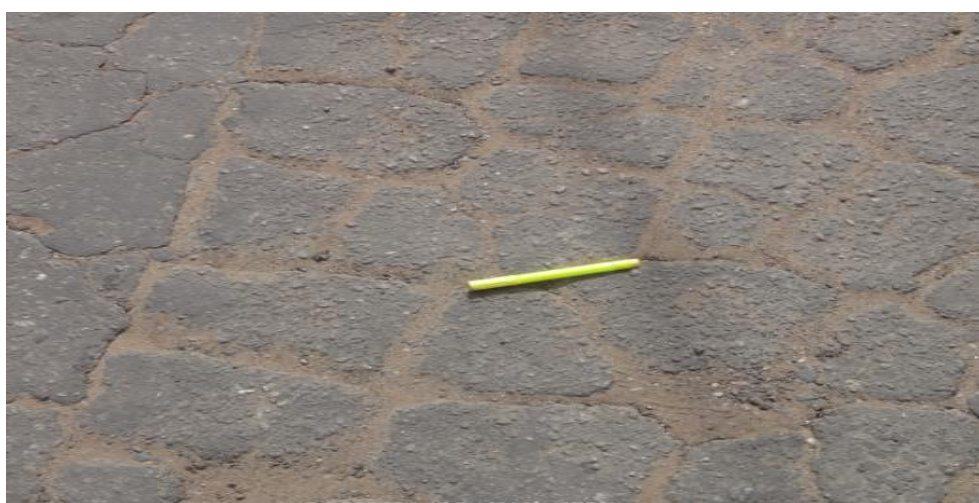
Figura 19 Trinca Tipo Bloco
