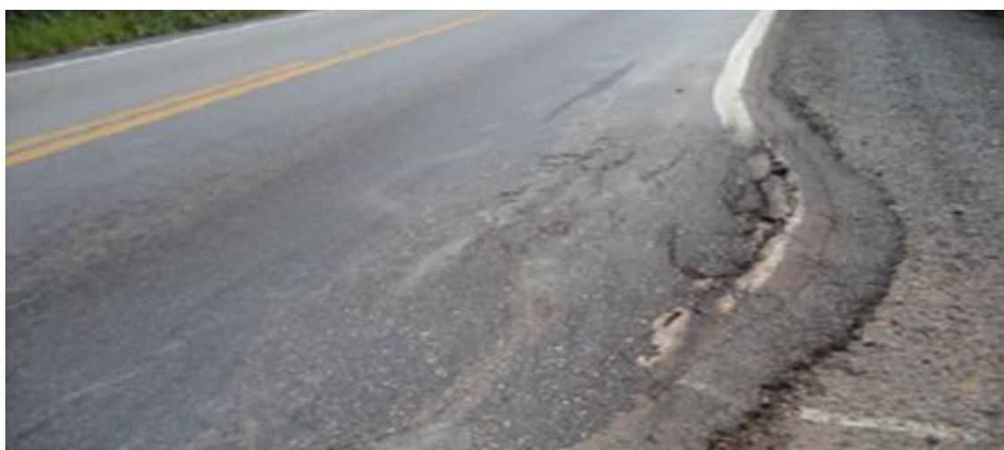
Figura 8 Escorregamento do Revestimento Betuminoso
