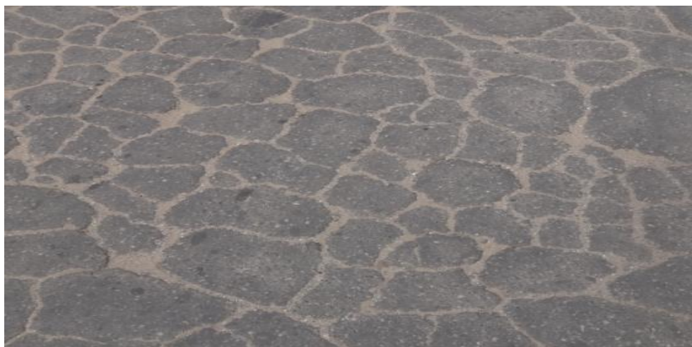
Figura 18 Trinca “couro de jacaré”
