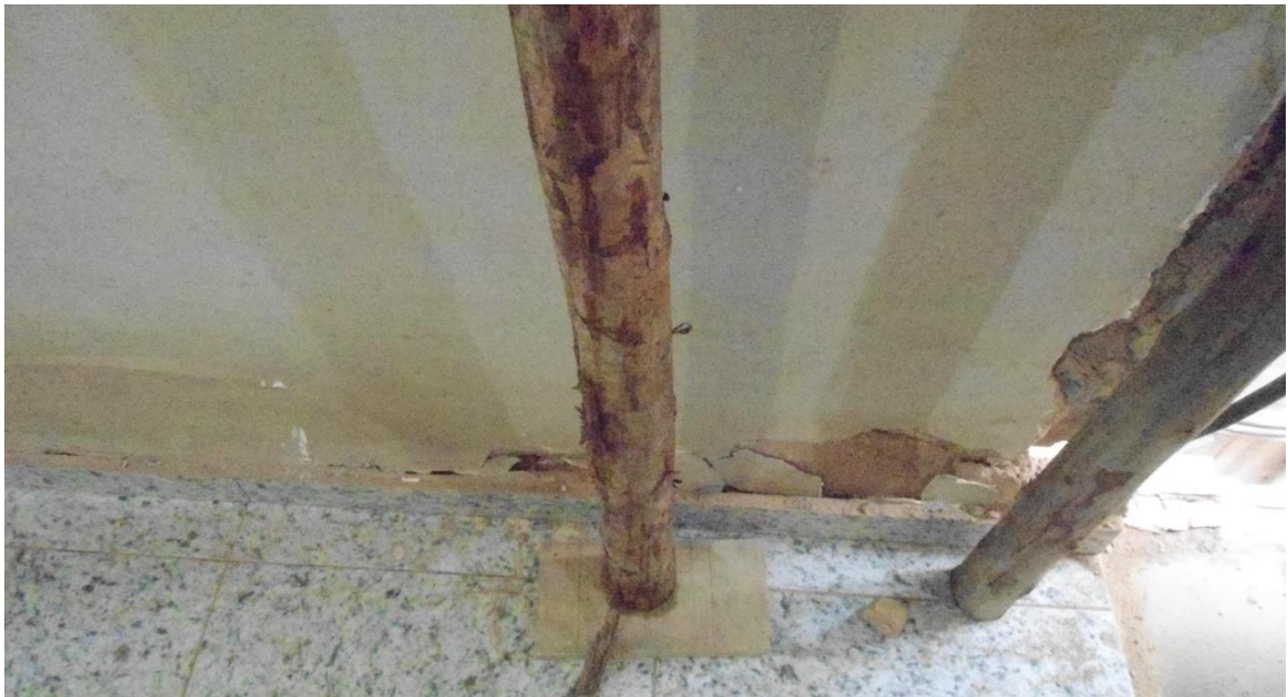
Figura 3-1: Parede danificada por esmagamento da alvenaria
