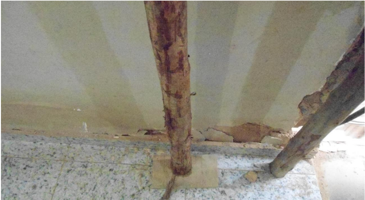
Figura 1-2: Parede danificada pelo esmagamento
