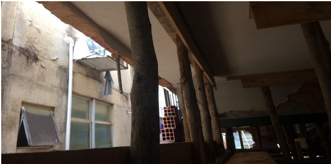
Figura 3-3: Edificação escorada e com parede demolida
