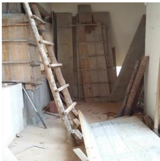
Figura 16: Restos de formas no local de passagem
