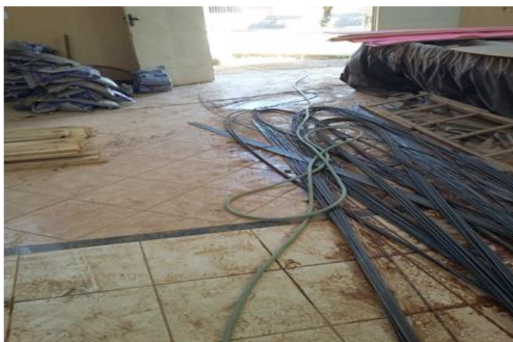
Figura 6: Materiais espalhados dentro da igreja
