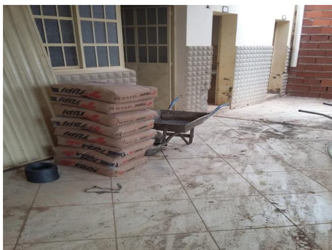
Figura 10: Armazenamento indevido dos sacos de cimento
