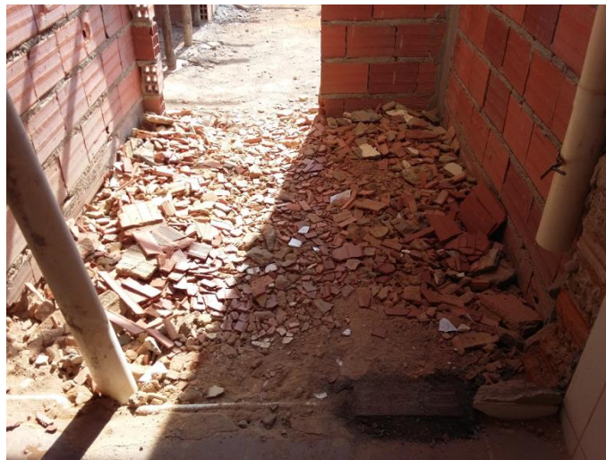
Figura 19: Restos de tijolos espalhados pelo chão
