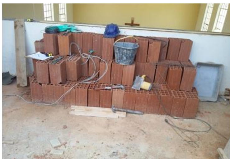
Figura 7: Equipamentos e materiais em local indevido
