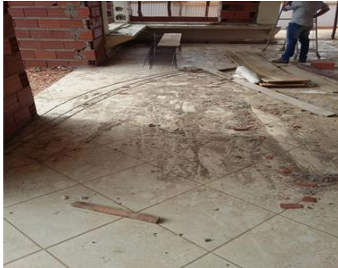
Figura 18: Ambiente sujo com restos de entulhos
