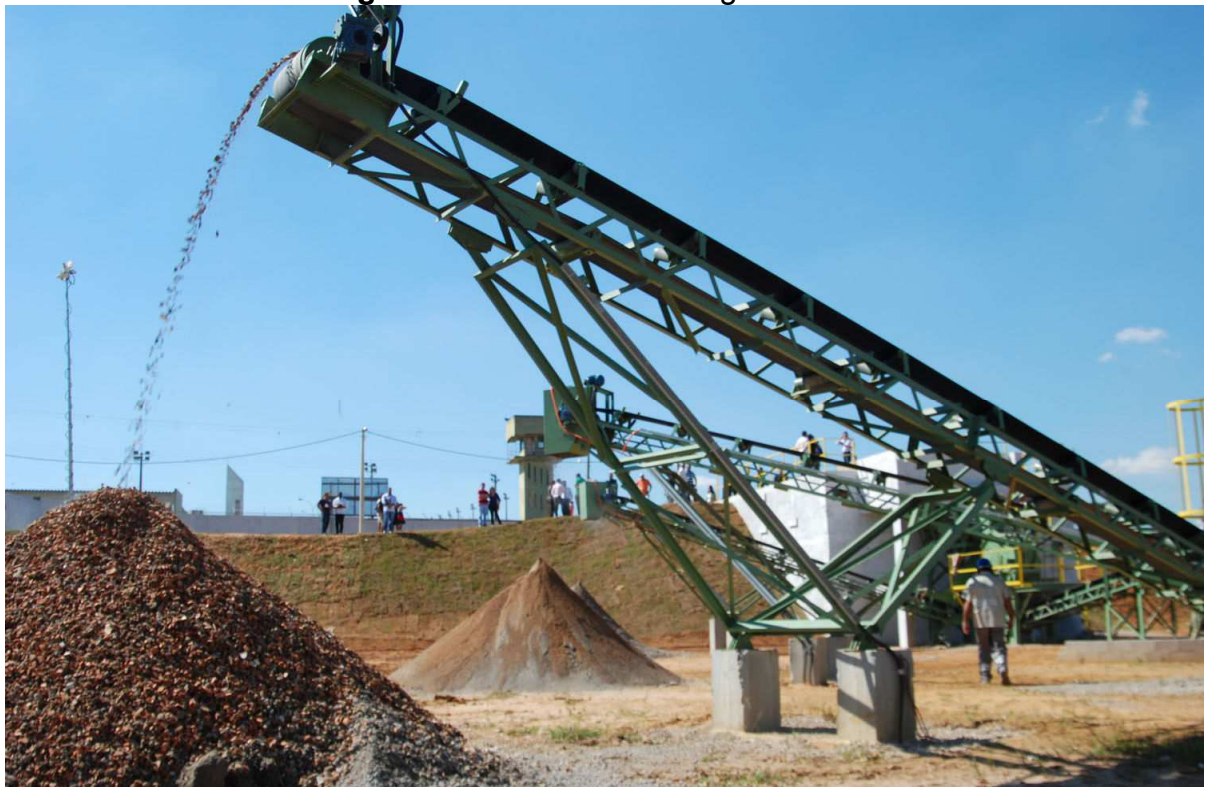
Figura 3: Usina fixa de britagem de entulhos.
