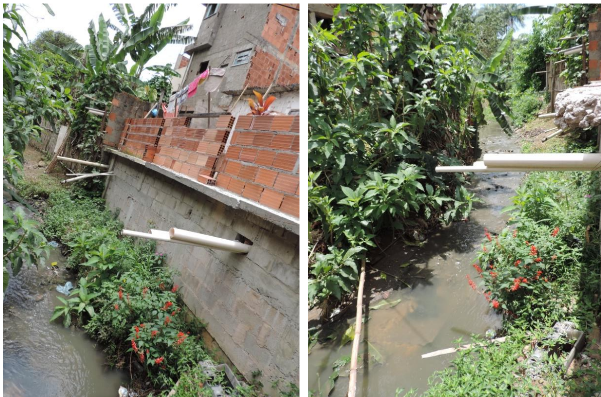
Fotos 11 e 12. Construções nas margens do córrego e despejo in natura do esgoto. Fonte: Arquivo Pessoal. Data: 03 de novembro de 2018.
