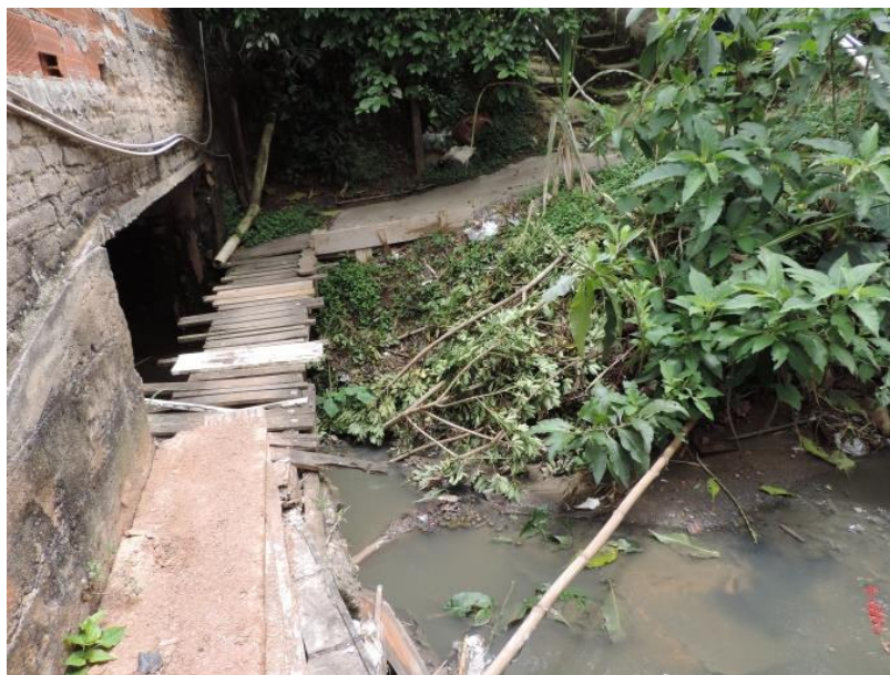
Foto 13. Fundação e ponte de acesso construída por moradores locais. Percebe-se falta de educação ambiental e fiscalização. Fonte: Arquivo Pessoal. Data: 03 de novembro de 2018.
