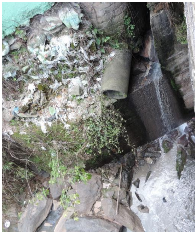
Foto 21. Despejo in natura do esgoto. Fonte: Arquivo Pessoal. Data: 03 de novembro de 2018.
