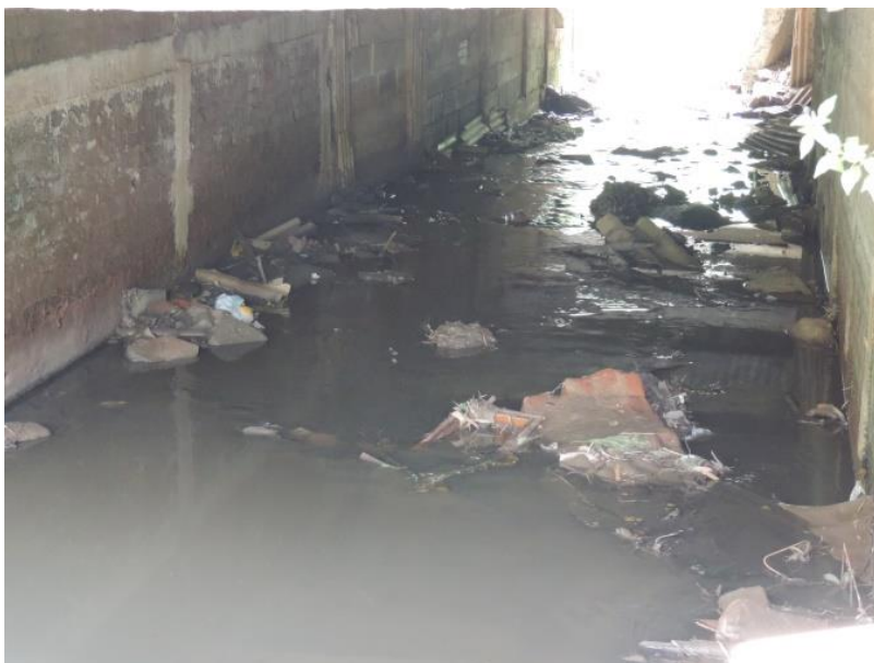
Foto 14. Descarte impróprio de resíduos e entulhos abaixo da fundação de concreto. Fonte: Arquivo Pessoal. Data: 03 de novembro de 2018.
