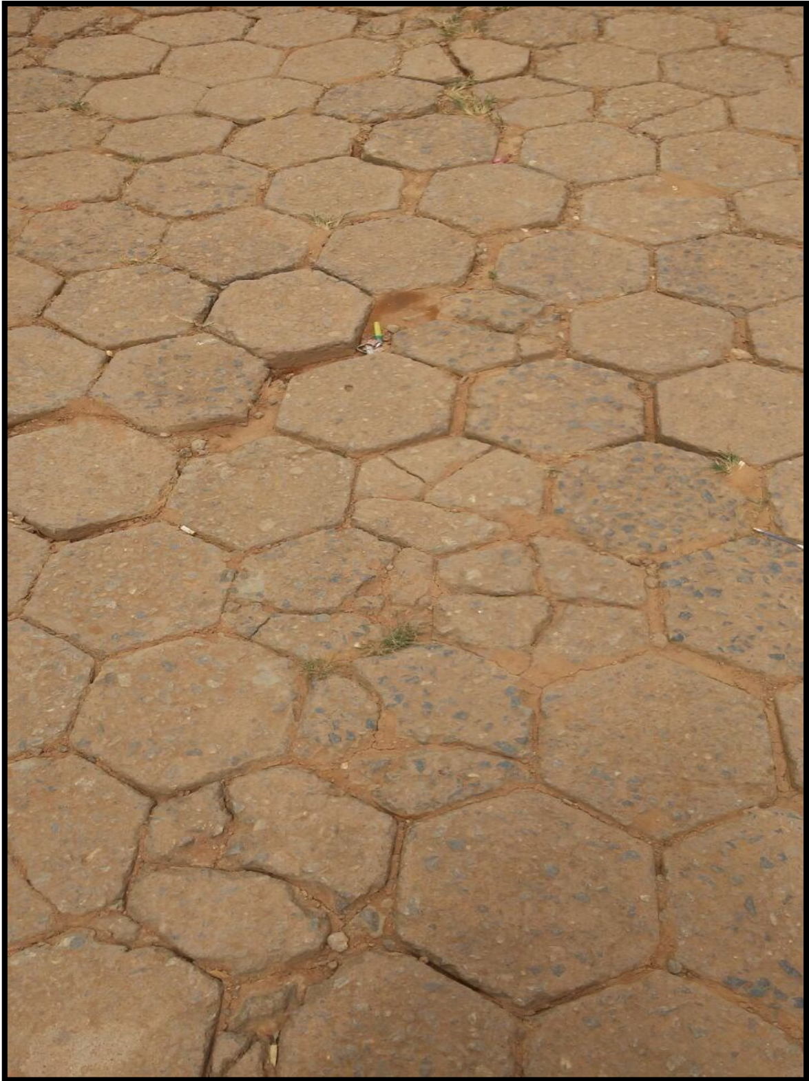
Figura 9: Fendilhamentos, afundamentos e desgastes superficial encontrados na Rua Joaquim Vieira Loures
