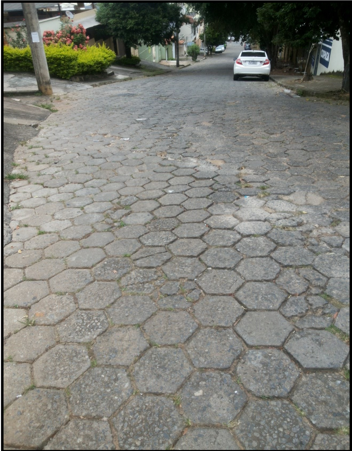
Figura 12: Fendilhamentos encontrados na Rua do Santuário
