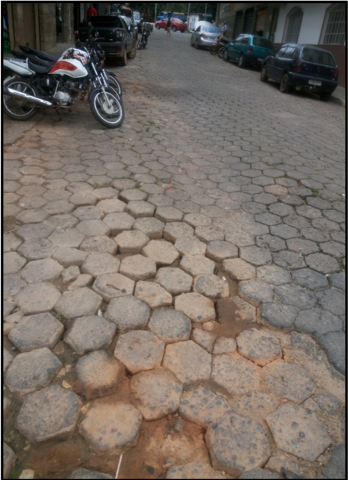
Figura 13: Painelas, fendilhamentos e afundamentos encontrados na Rua Geraldo Cevidanes
