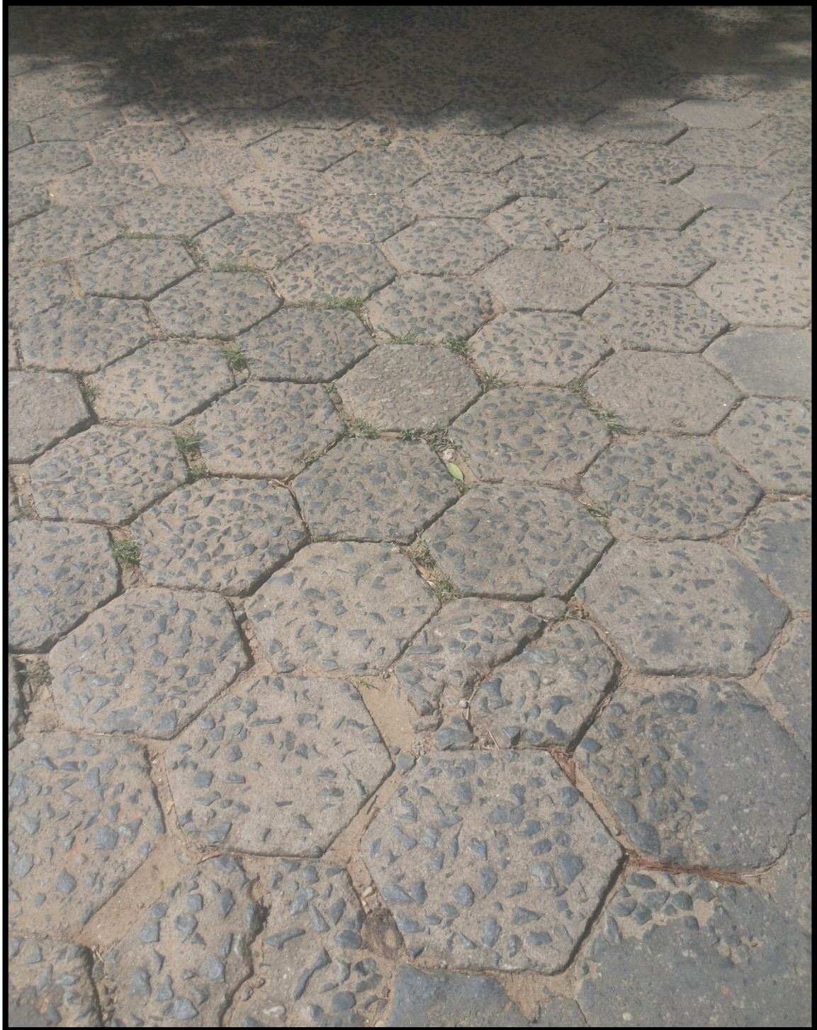
Figura 8: Fendilhamentos e desgastes superficial encontrados na Rua Raymundo Cimini
