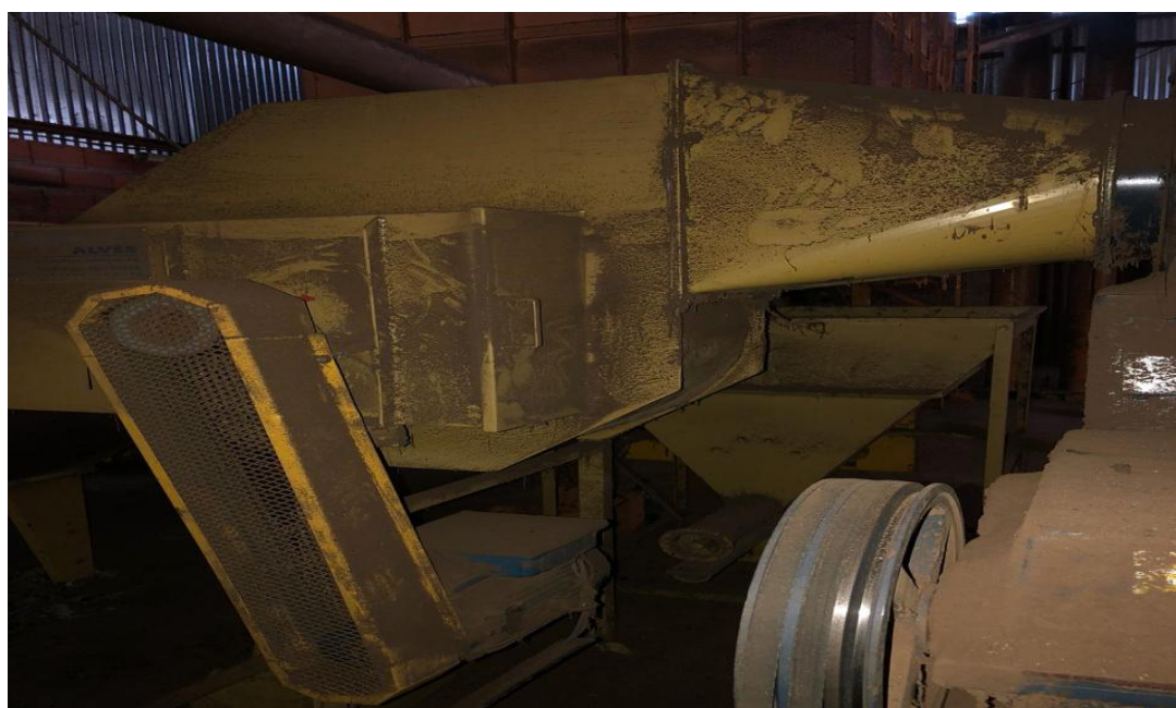
Figura 2: Turbina, responsável por enviar o calor gerado pela fornalha para dentro do secador acionada por um motor.
