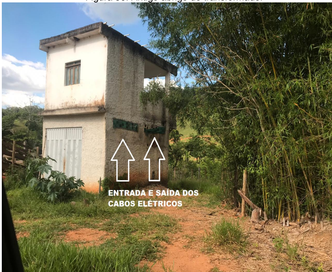
Figura 50: Antigo abrigo do transformador
