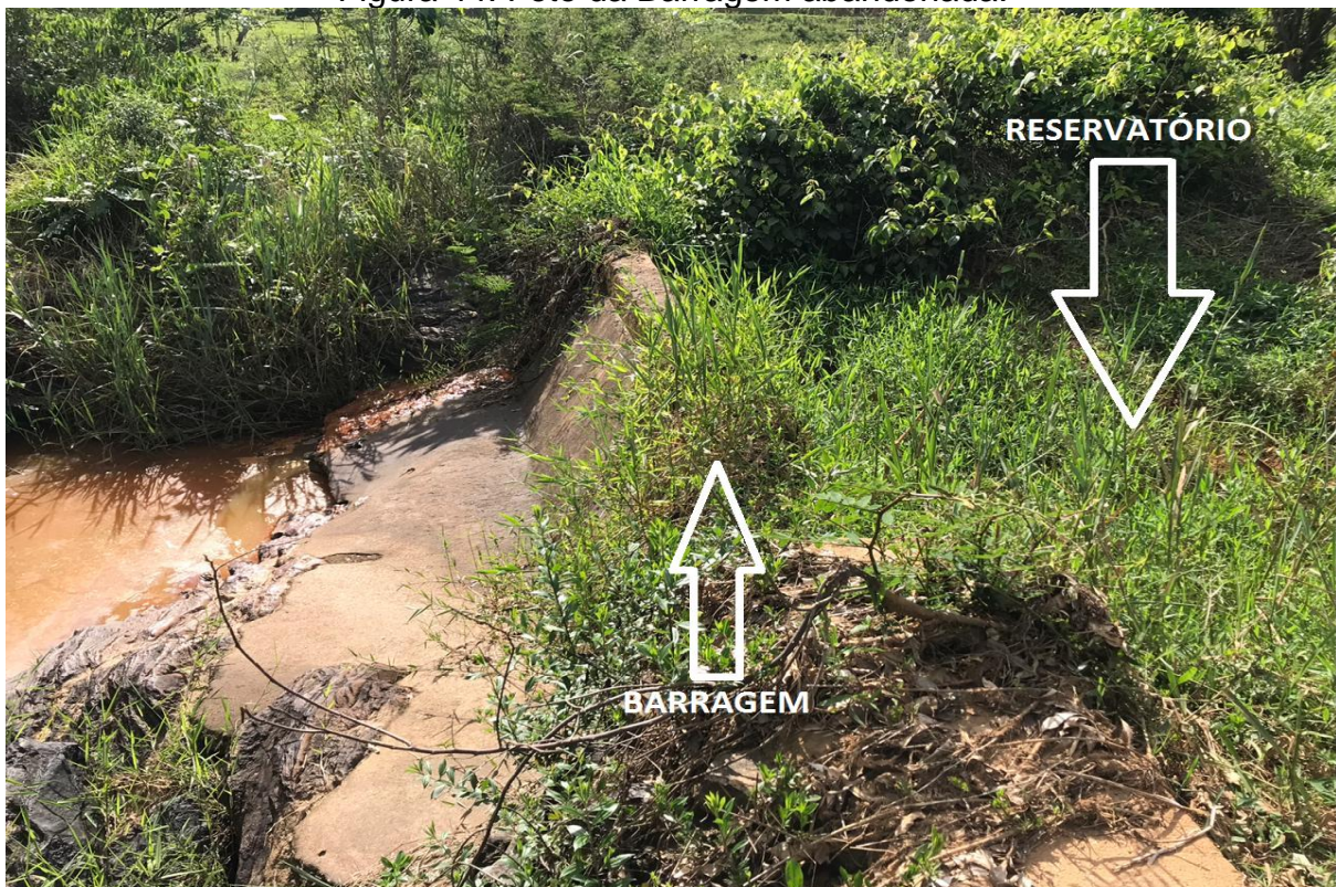
Figura 44: Foto da Barragem abandonada.
