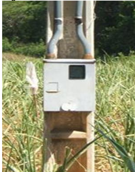
Figura 53: Medidor CEMIG local
