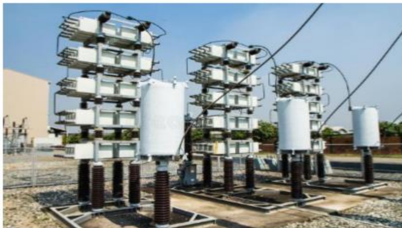
Figura 10 - Banco de Capacitores
