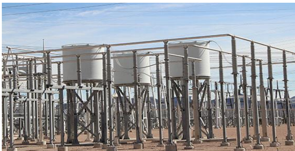
Figura 12 - Banco de Reatores
