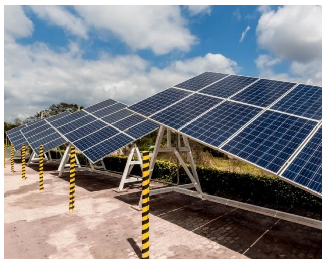
Figura 26 - Conjunto de módulos da usina
