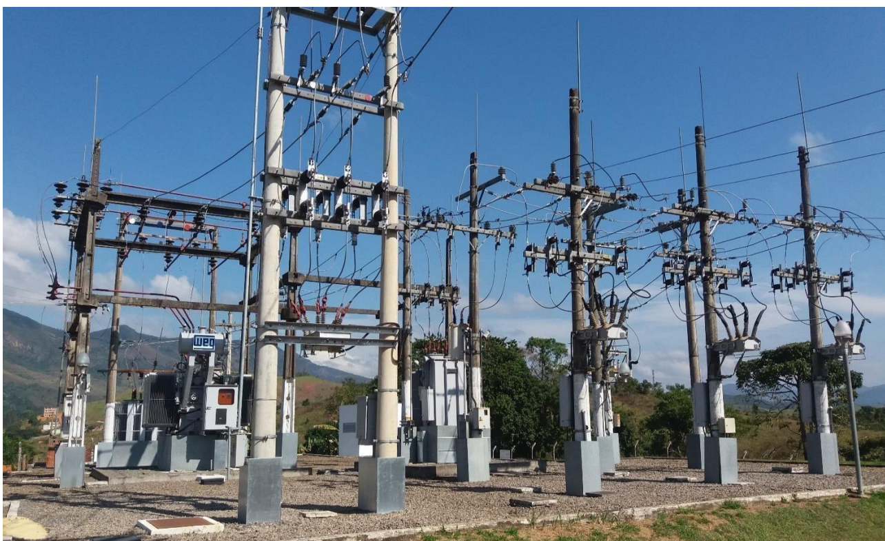
Figura 21 - Subestação Lima Duarte
