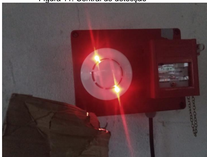
Figura 11: Central de detecção
