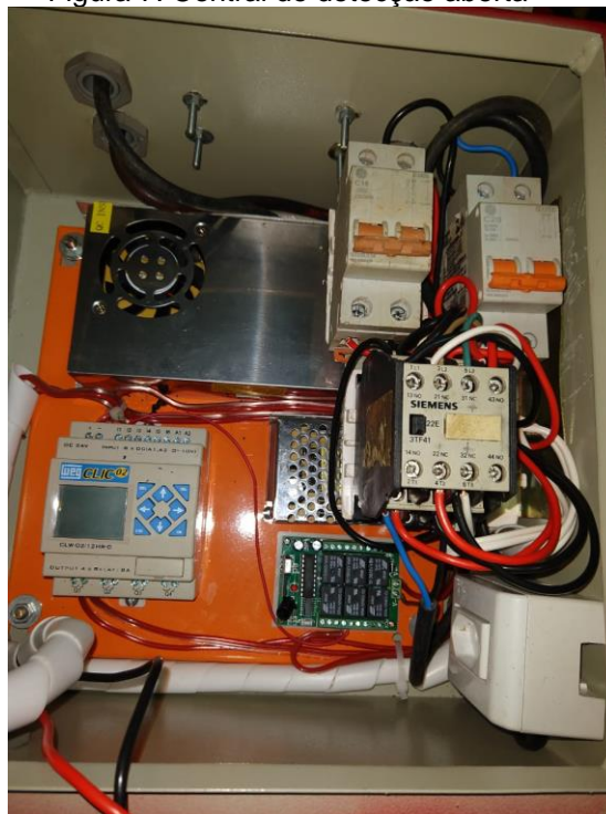
Figura 7: Central de detecção aberta
