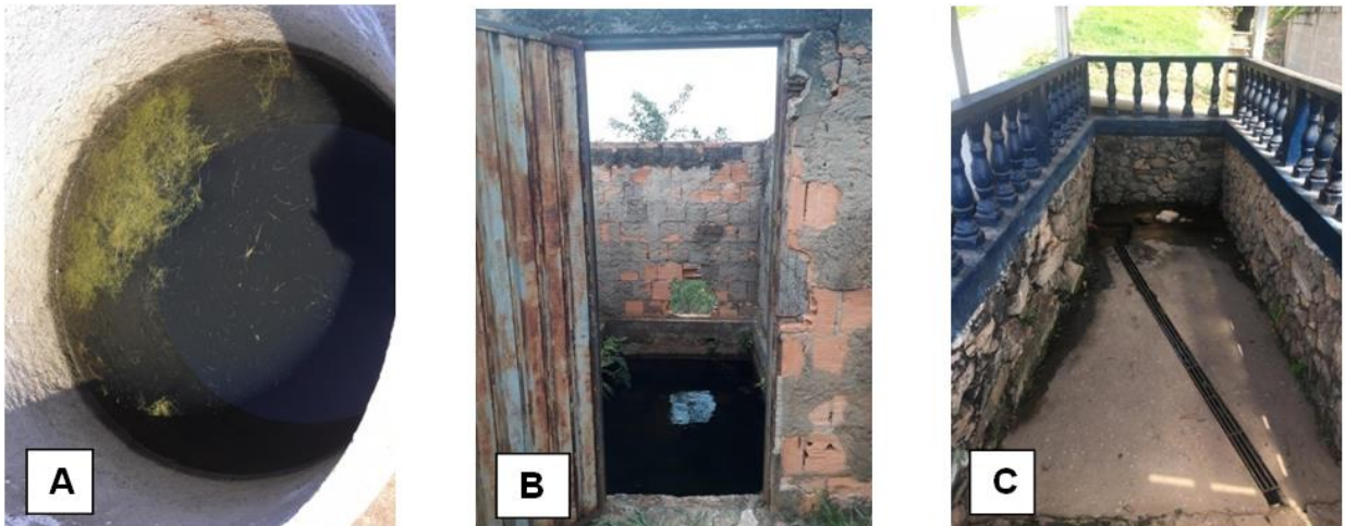
Figura 2: Locais onde foram feitas as coletas. A) ETA (Estação de tratamento de água); B) Nascente 1 (localizada ao lado da ETA); C) Nascente 2.
