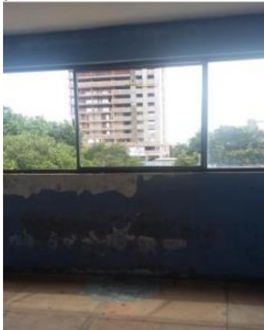
Figura 6 - Deslocamento de revestimento interno
