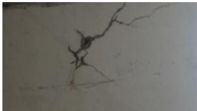
Figura 8 - Fissura radial em parede
