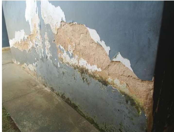
Figura 7 - Deslocamento de revestimento
