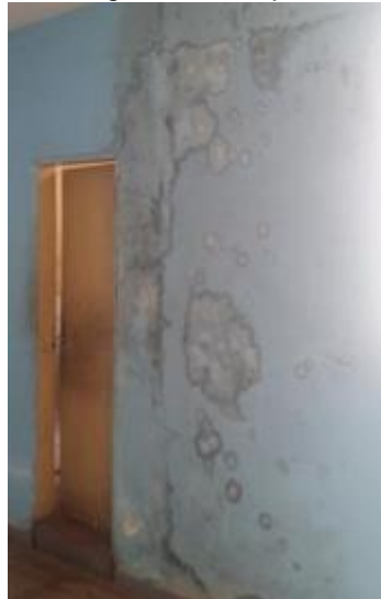
Figura 2 - Patologia causada pela condensação
