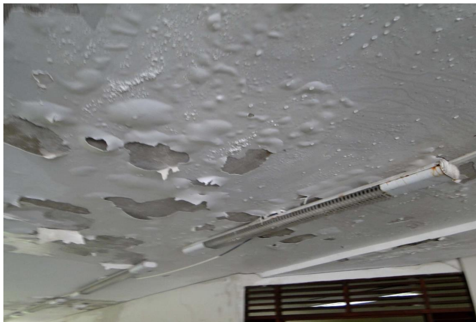
Figura 7 – Goteiras e manchas no teto
