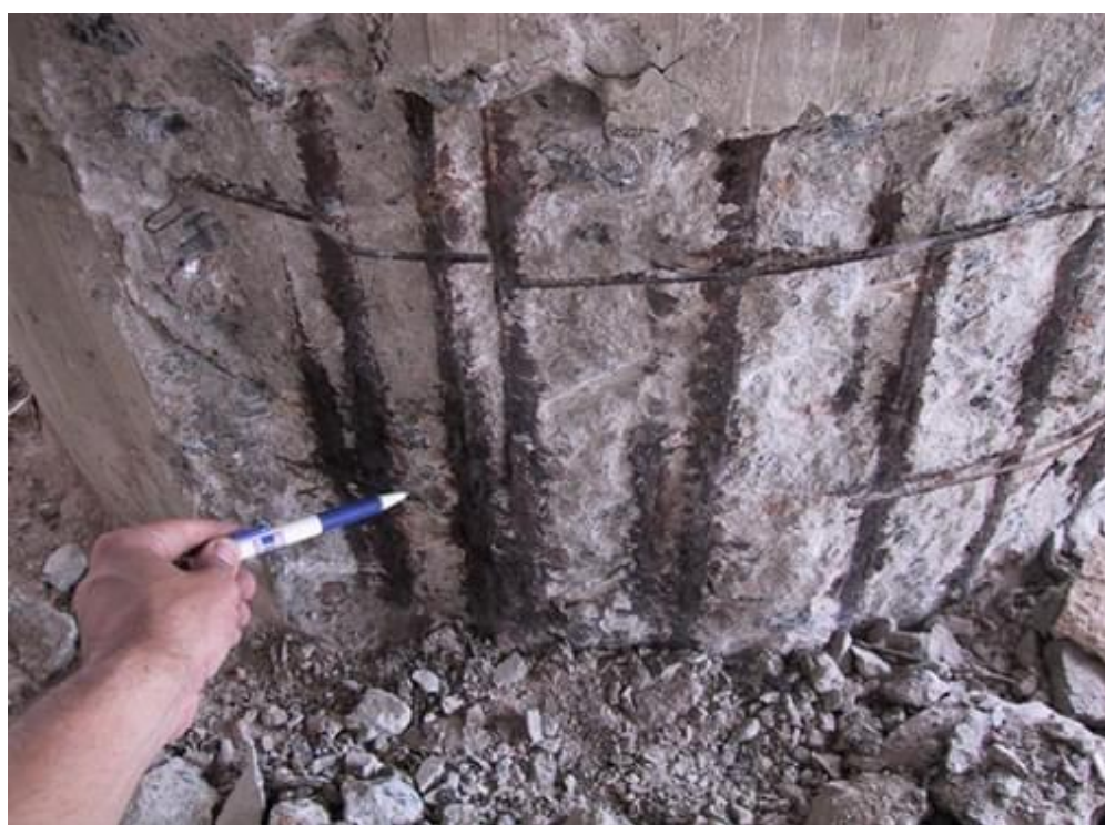
Figura 10 – Carbonatação do concreto
