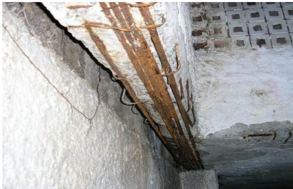
Figura 9 – Oxidação das armaduras
