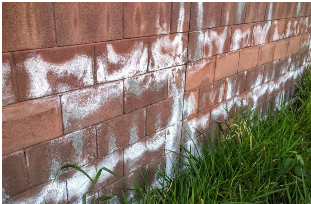
Figura 11 - Eflorescências nas alvenarias de blocos cerâmicos
