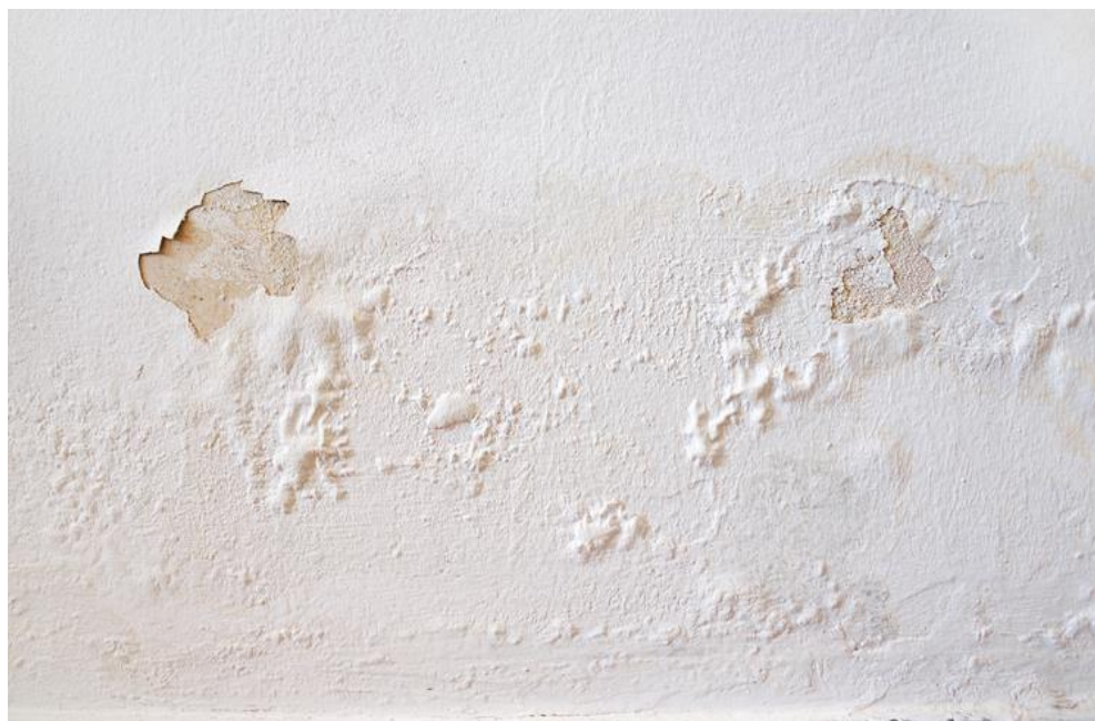
Figura 14 – Saponificação na superfície da parede
