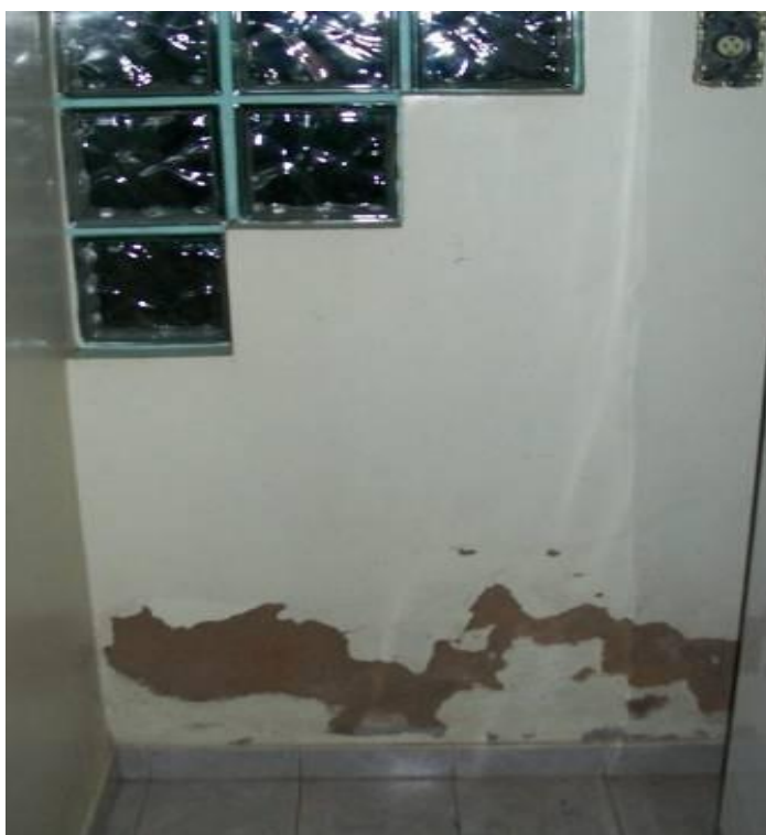
Figura 23 – Patologia na parede com revestimento em reboco e pintura
