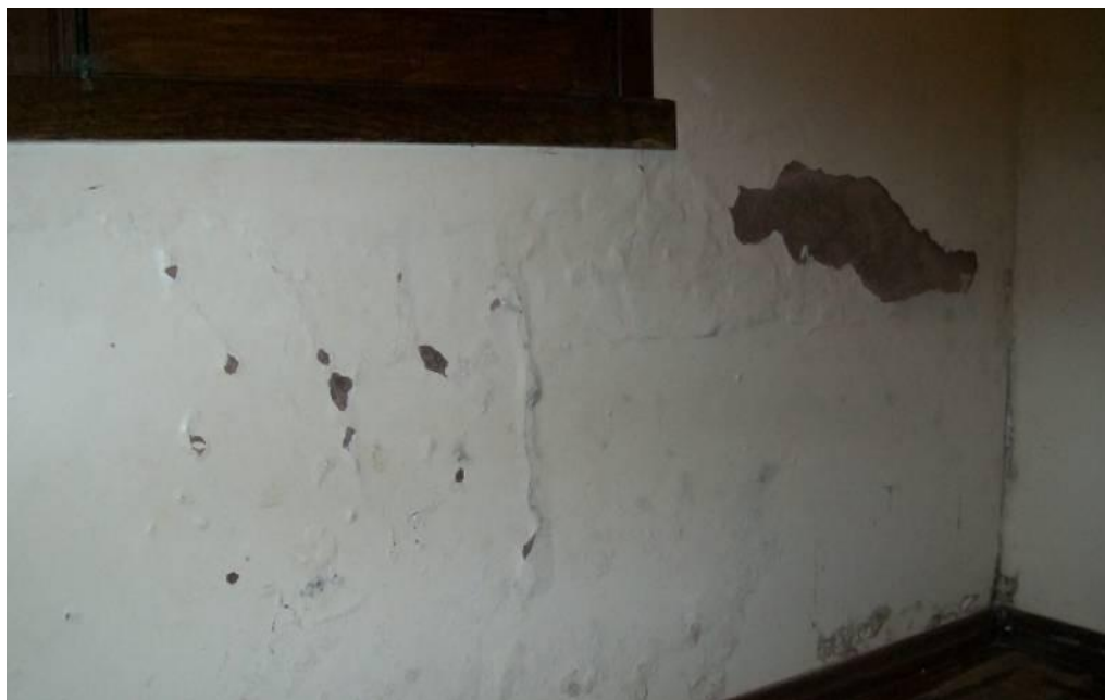
Figura 30 – Patologia na parede com revestimento em reboco e pintura
