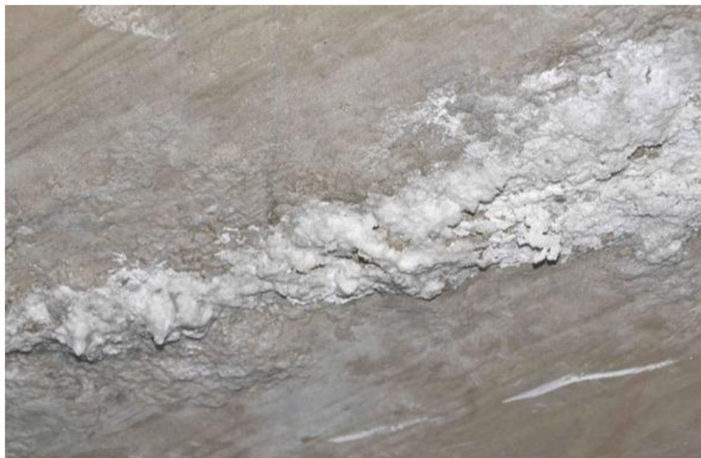
Figura 12: Criptoflorescências em alvenaria de concreto
