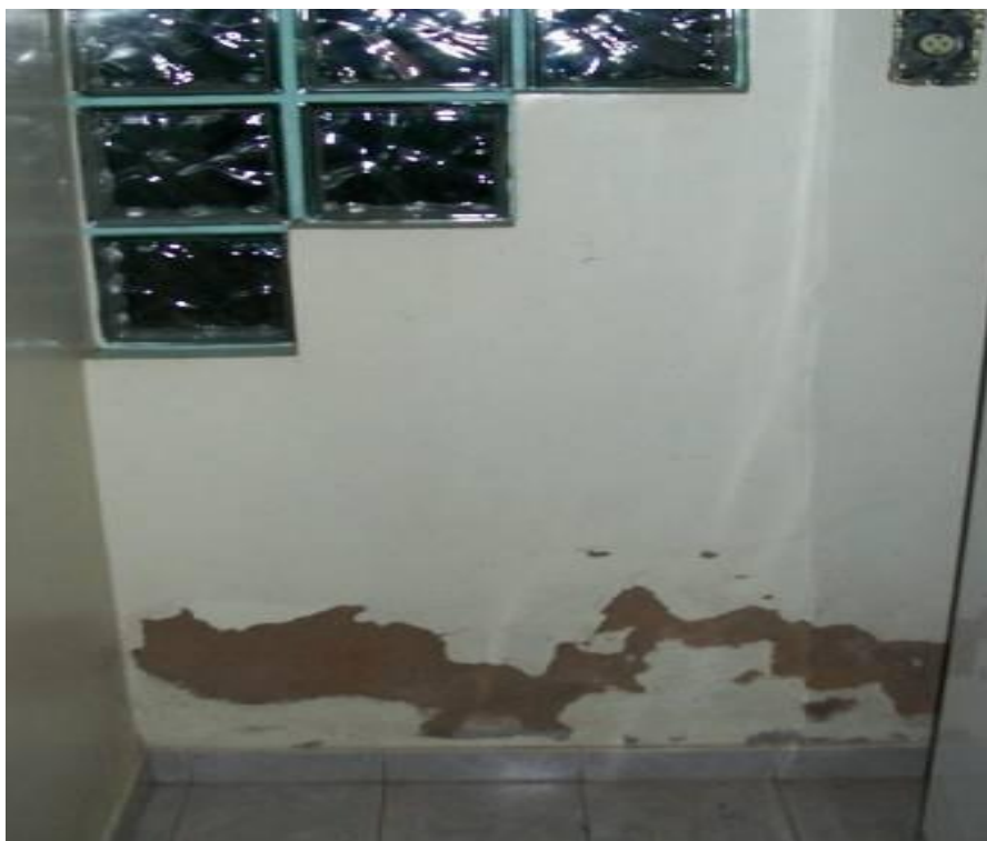
Figura 34 – Patologia na parede com revestimento em reboco e pintura
