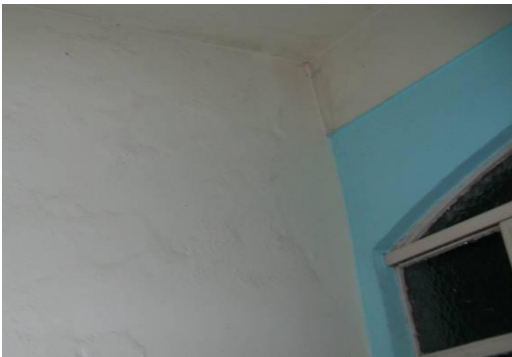
Figura 32 – Patologia na parede com revestimento em reboco e pintura
