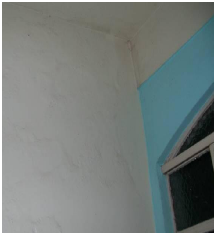
Figura 24 – Patologia na parede com revestimento em reboco e pintura
