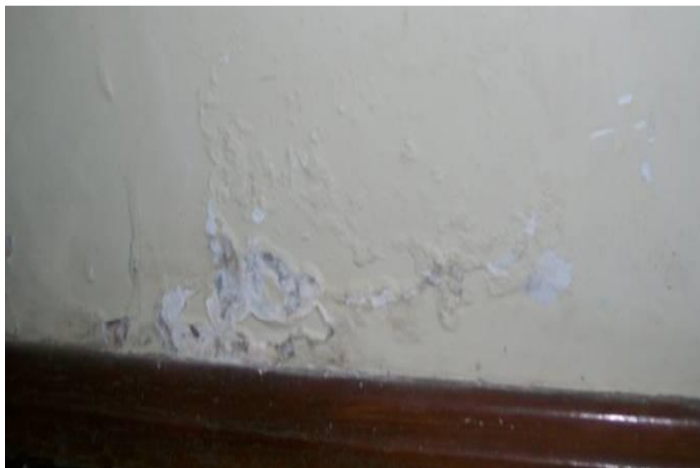
Figura 28 – Patologia na parede com revestimento em reboco e pintura
