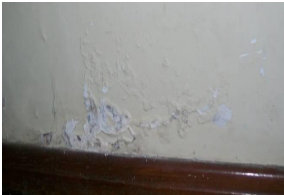
Figura 22 – Patologia na parede com revestimento em reboco e pintura
