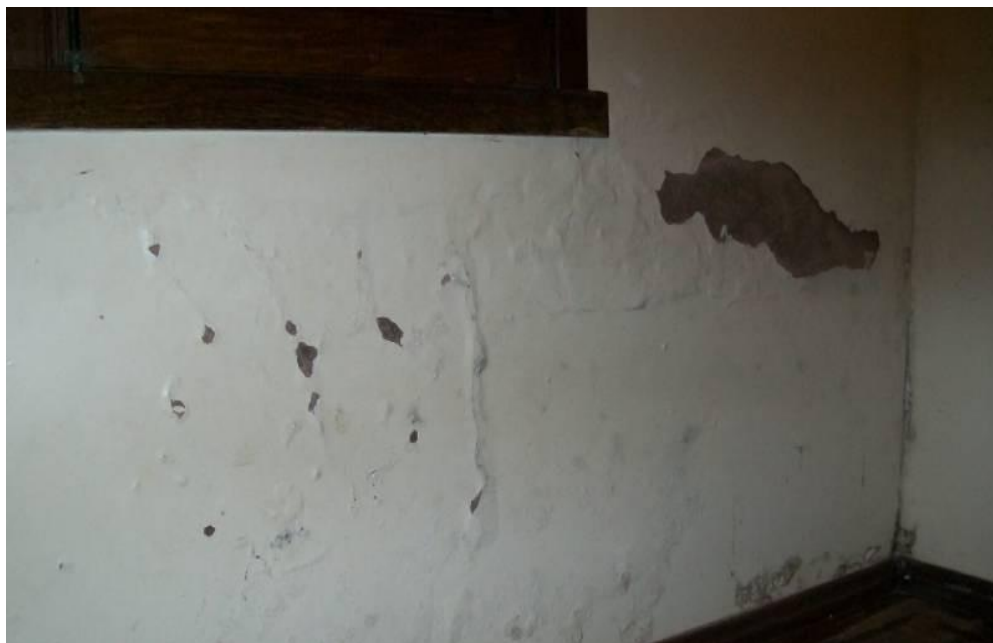
Figura 2 – Patologia na parede com revestimento em reboco e pintura
