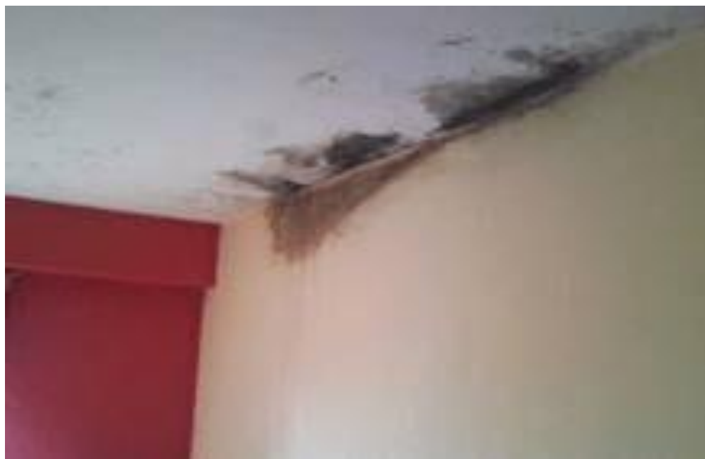
Figura 25 – Pintura do teto comprometida
