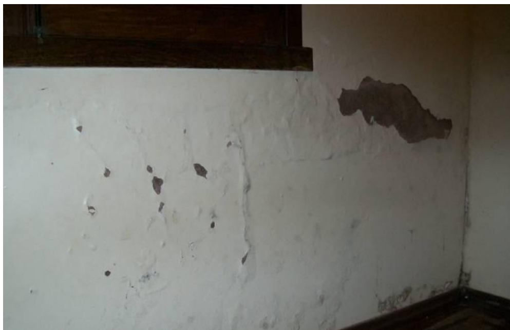
Figura 21 – Patologia na parede com revestimento em reboco e pintura
