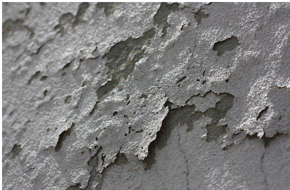
Figura 13 – Desagregamento da pintura
