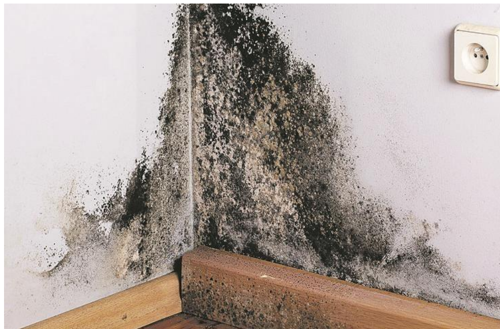
Figura 8 – Mofo e apodrecimento na parede
