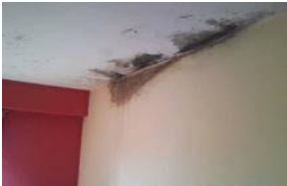
Figura 4 – Pintura da cobertura comprometida
