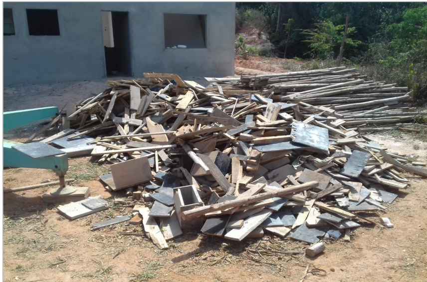
Figura 18: Desperdício de materiais no canteiro
