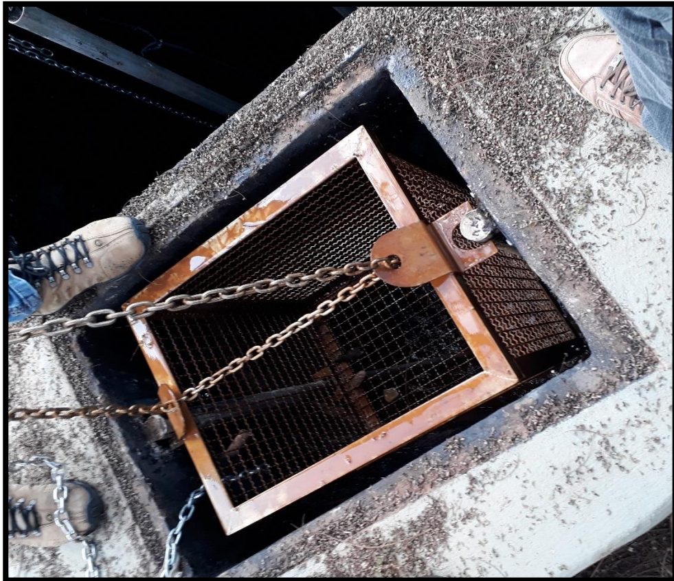
Figura 17: Sistema de Gradeamento
