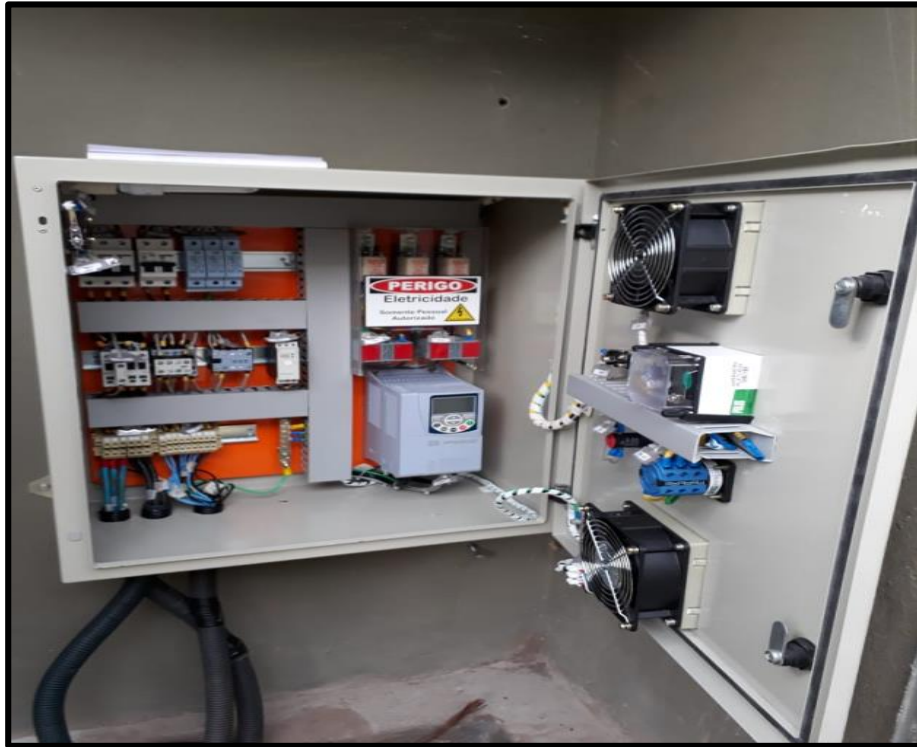
Figura 18: Caixa de Distribuição da ETE
