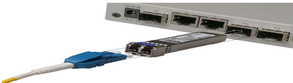
Figura 23 – Transceiver para conexão de cordão óptico em Switch
