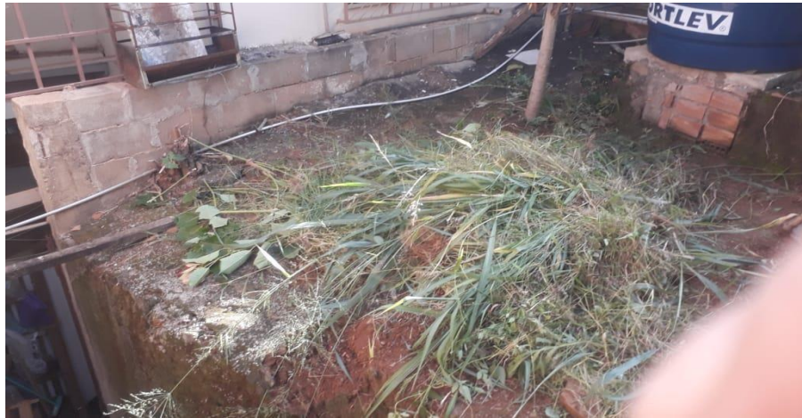
Figura 7: Muro de arrimo da residência.
