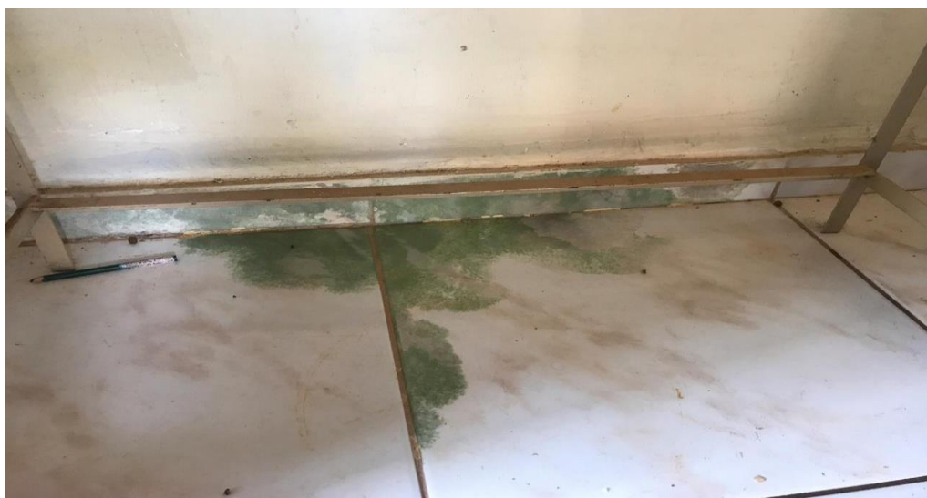
Figura 11: Umidade por capilaridade no piso e parede.
