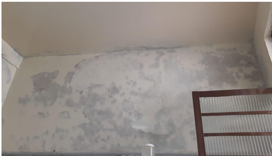
Figura 8: Parede com infiltração.
