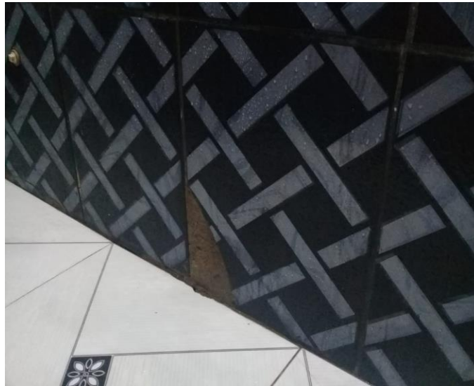
Figura 4: Destaque do revestimento cerâmico danificado.
