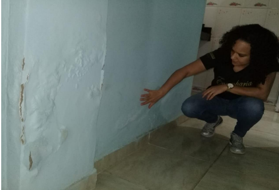
Figura 6: Presença de fissuras na parede.
