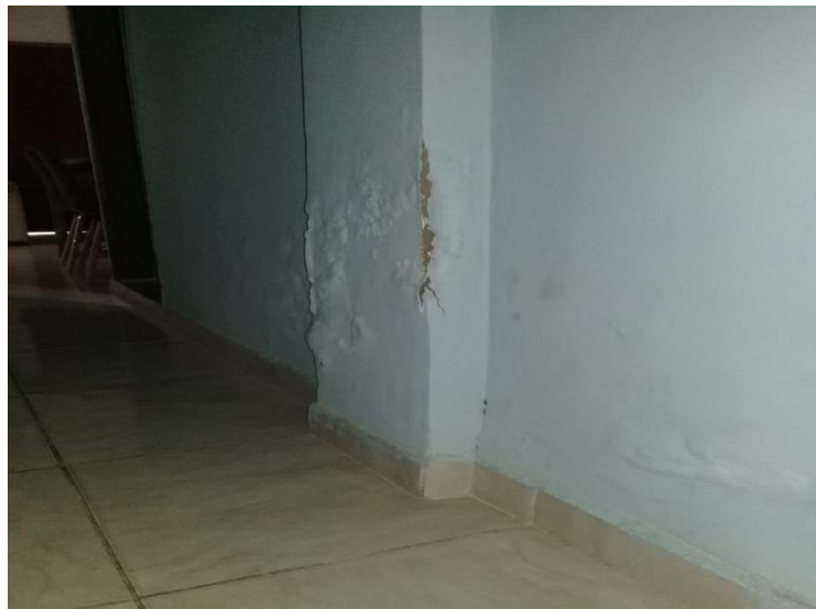
Figura 5: Parede com presença de umidade por vazamento nas tubulações.
