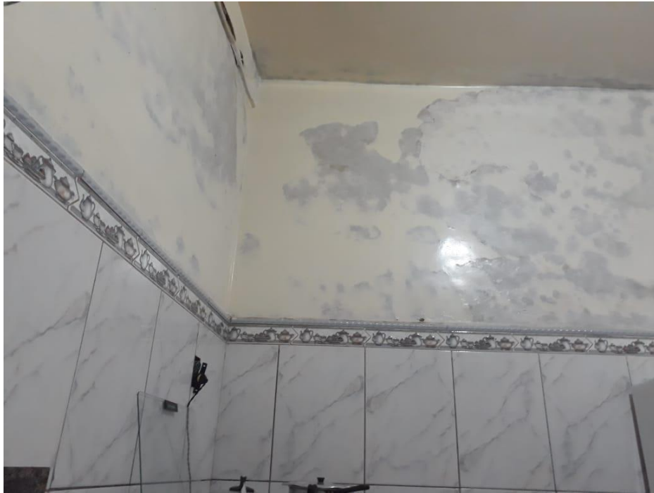
Figura 9: Parede com revestimento na parte inferior e patologia na parte superior.
