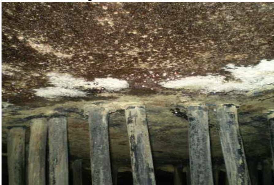
Figura 4: Corrosão no teto da estrutura.
