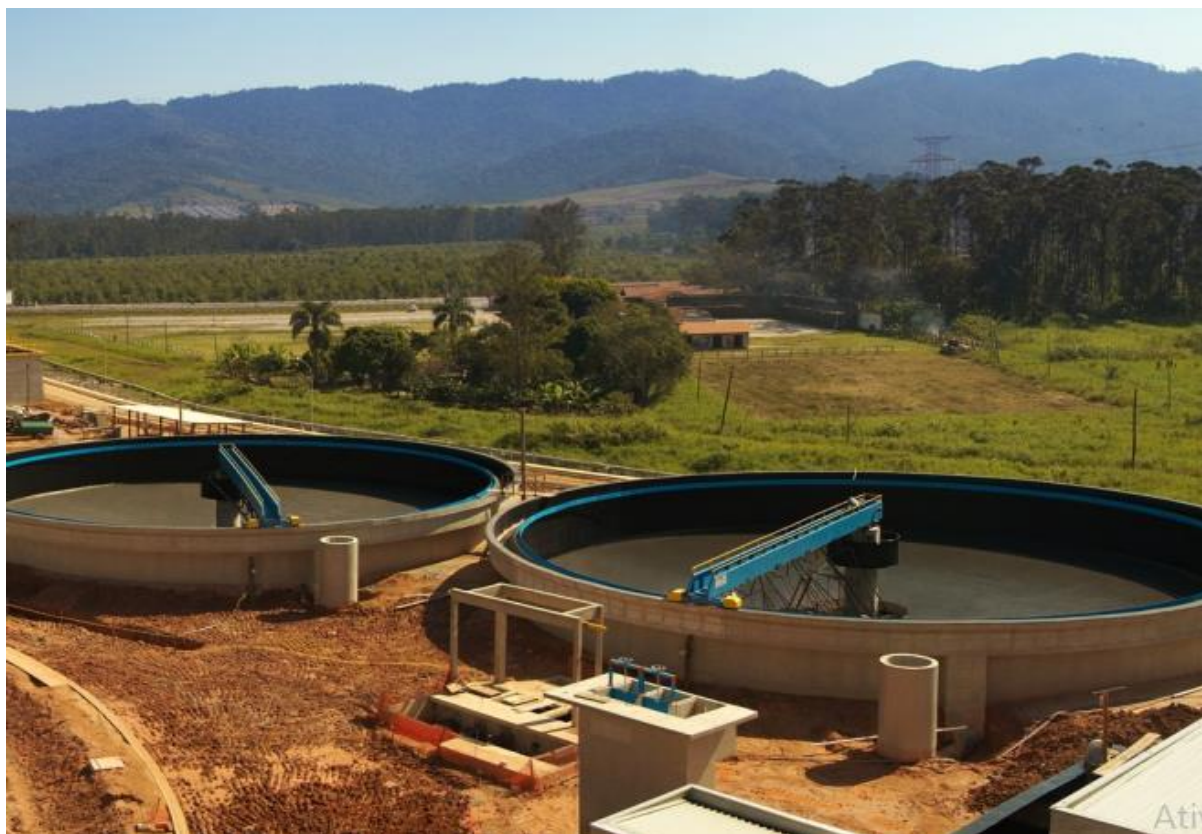
Figura 5: Tanques de ETEs impermeabilizadas com membrana de poliuretano.
