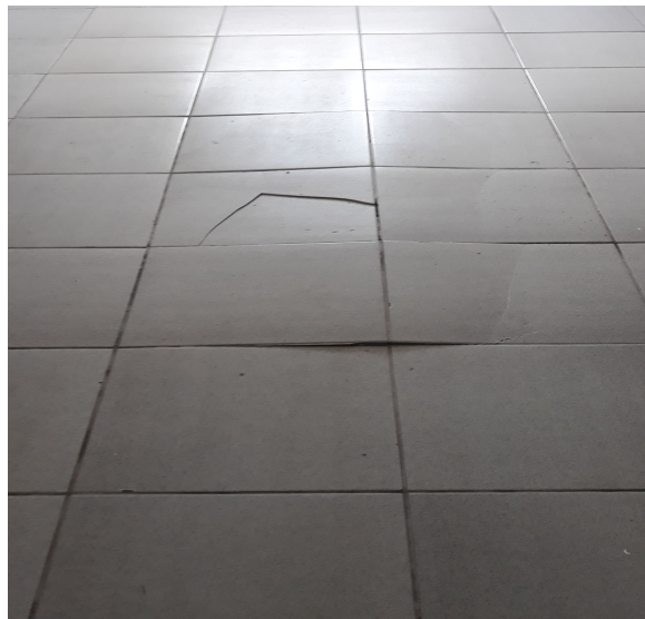
Figura 2: Deslocamento cerâmico Fonte: Autores (2019)
