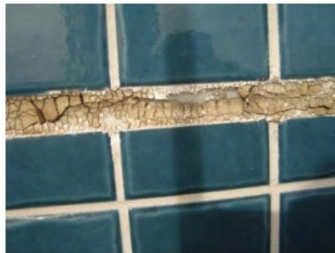
Figura 4: Deterioração das juntas Fonte: Galletto; Andrello (2013)
