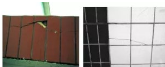
Figura 3: Trincas e Fissuras Fonte: InovaCivil (2019).
