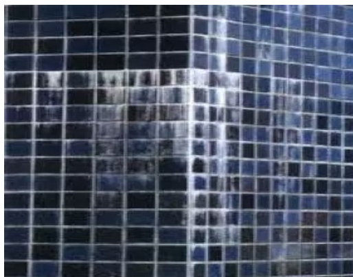
Figura 5: Eflorescência Fonte: Inovacivil (2019)
