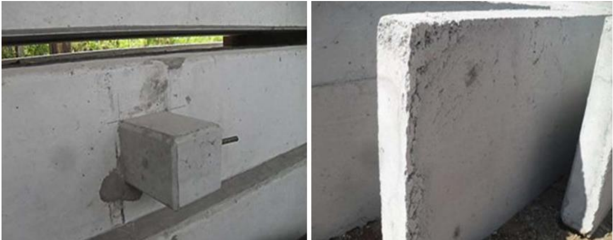
Figura 08: falhas de acabamento em peças pré-moldadas de concreto. Fonte: MILANI, 2012.
