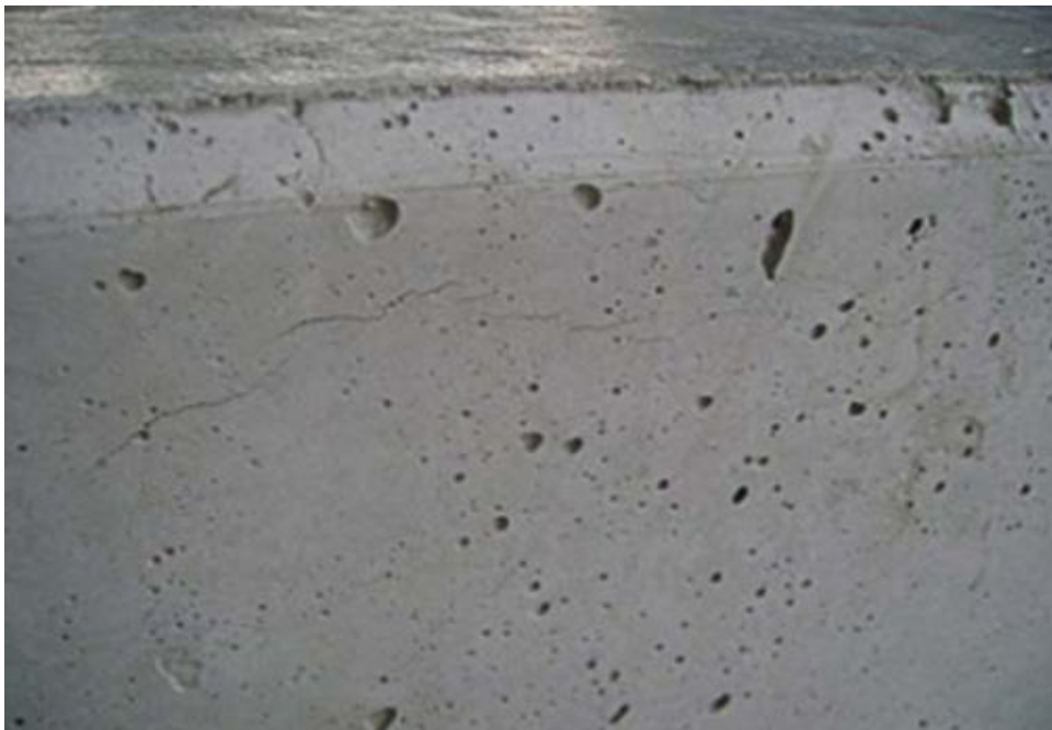
Figura 07: bolhas em peças pré-moldadas de concreto. Fonte: MILANI, 2012.
