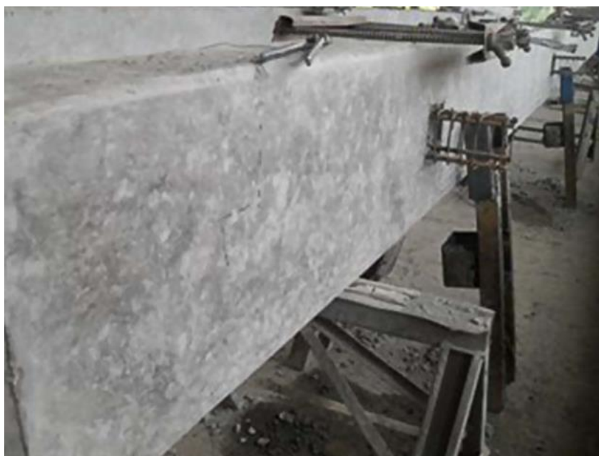
Figura 05: manchas em peças pré-moldadas de concreto. Fonte: MILANI, 2012.
