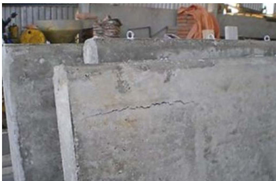
Figura 06: fissuras em peças pré-moldadas de concreto. Fonte: MILANI, 2012.
