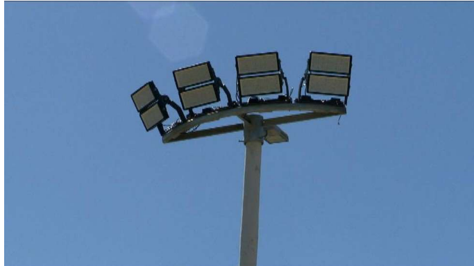
Figura 9 – Luminárias em Leds
