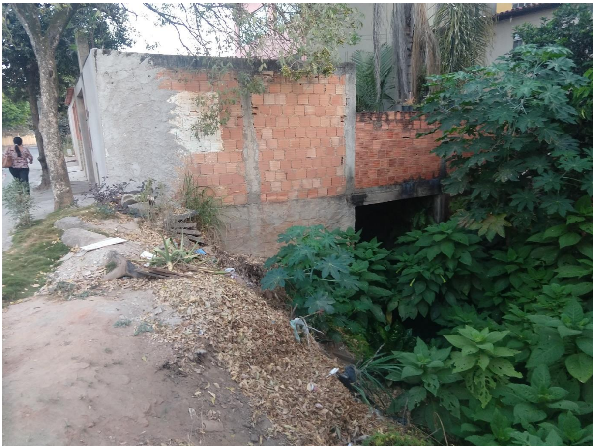
Figura 7 – Construções sobre o córrego São Jacinto no bairro São Jacinto em Teófilo Otoni-MG
