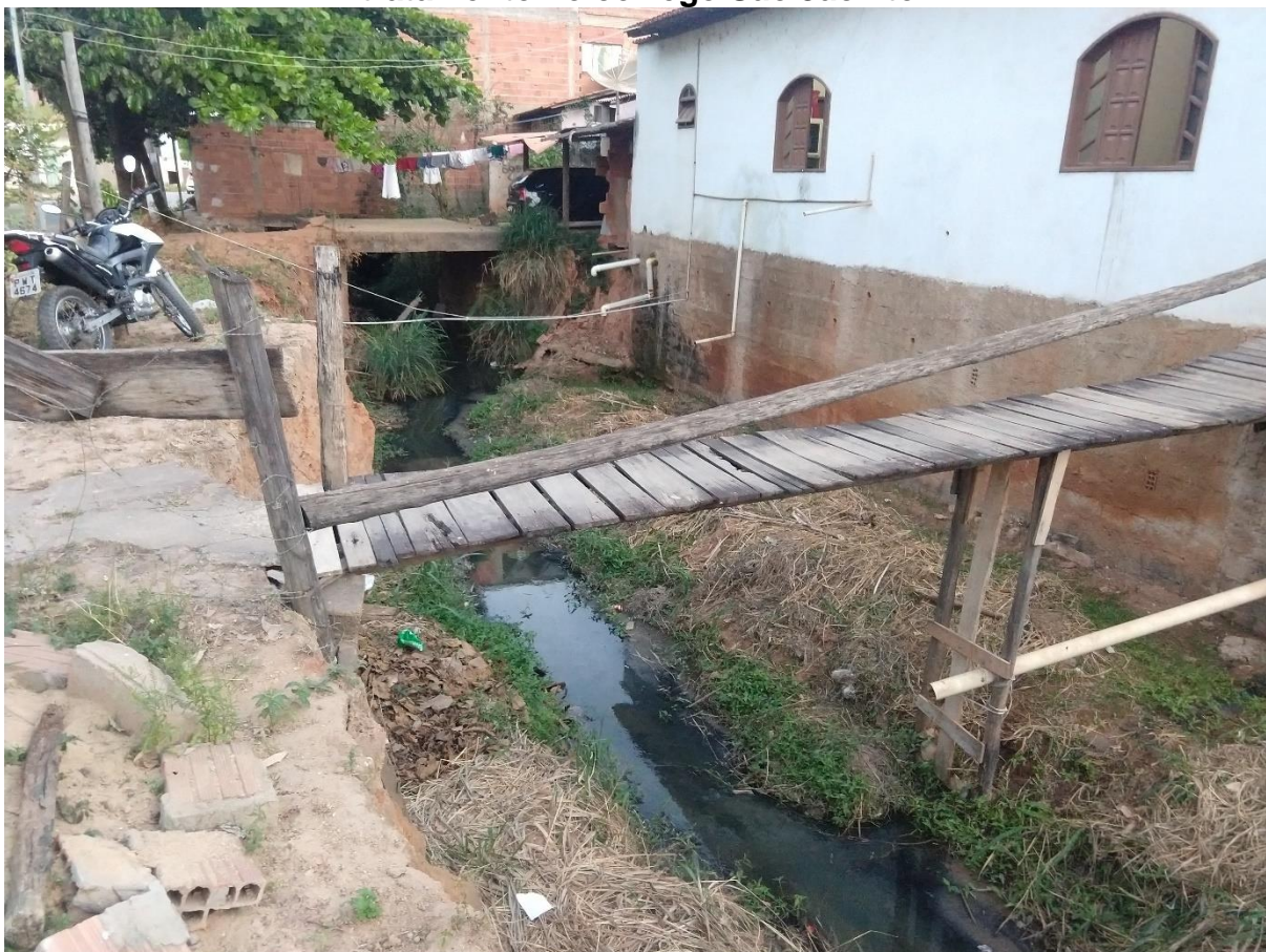
Figura 9 – Lançamento de Esgoto doméstico sem nenhum tipo de tratamento no córrego São Jacinto
